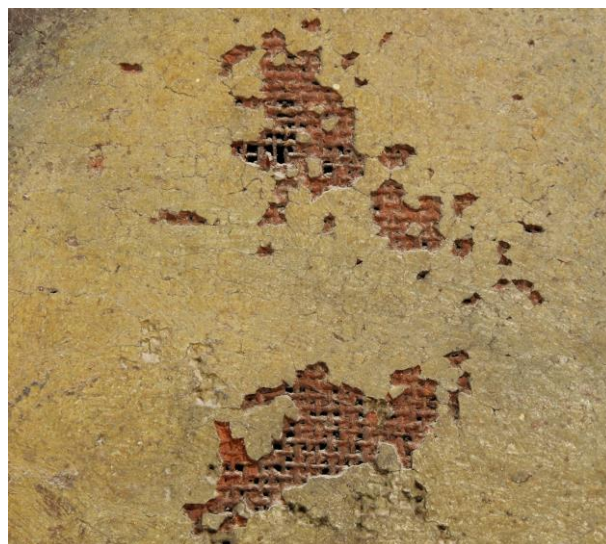
Figura 2. Detalle de las lagunas que presenta la obra objeto de estudio.
