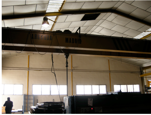
Fig. 19: puente – grúa de la empresa
