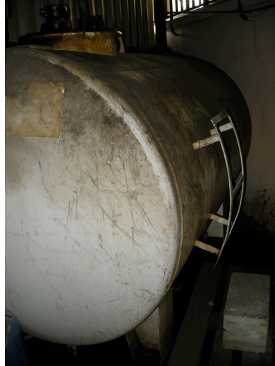
Fig. 59: depósito de gasoil
