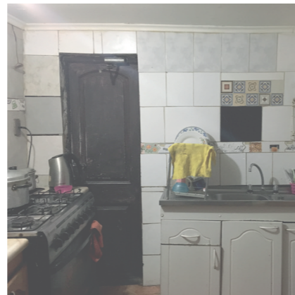
COCINA FALTA DE LUZ Y VENTILACIÓN
