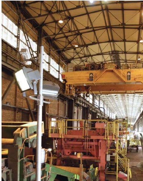
Ilustración 13. Puente grúa en la línea de decapado / Fuente: (ArcelorMittal Sagunto, 2009)
