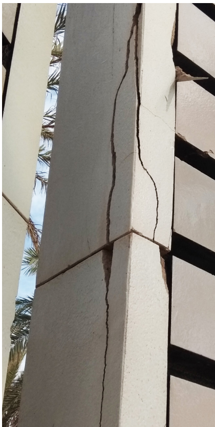
Figura 42. Detalle de grietas
