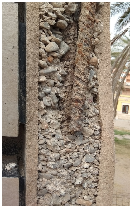
Figura 41. Detalle en el que se observa la armadura sin unir
