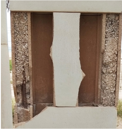
Figura 38. Pérdida de material cerámico
