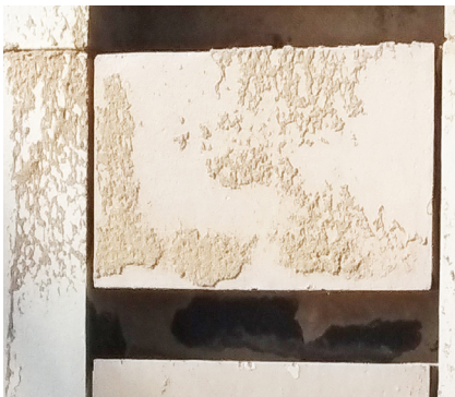
Figura 45. Depósitos de arena en superficie
