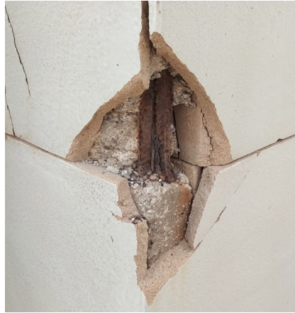
Figura 39. Pérdida de material cerámico
