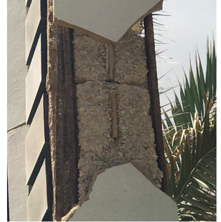
Figura 40. Pérdida de material cerámico
