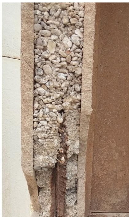
Figura 31. Detalle de granulometría y oquedades que presenta el hormigón.
