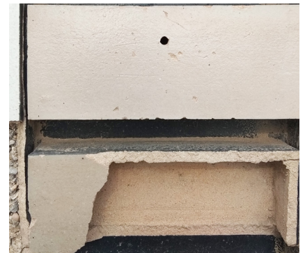
Figura 47. Pérdida de material cerámico causado por acto vandálicos.
