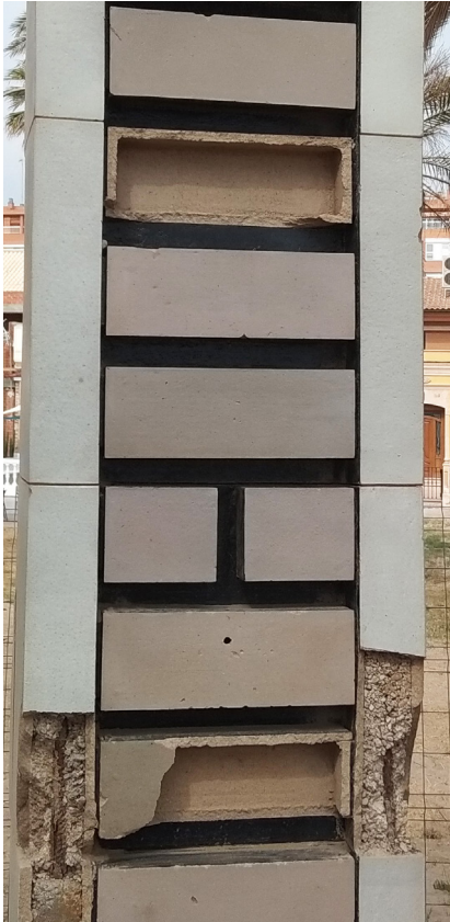
Figura 53. Detalle de dos faltantes de 30 x 15 cm. en los que se realizarán piezas nuevas.
