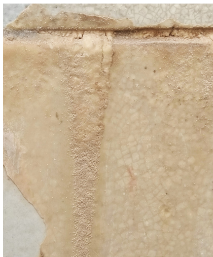
Figura 61. Detalle de costra formada por sales en la unión entre módulos.
