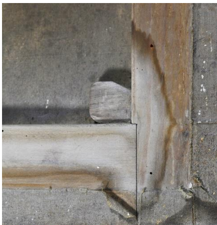
Figura 56: Daños por humedad en el bastidor.
