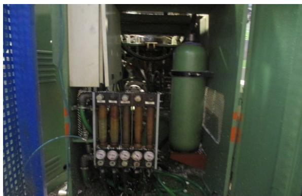
Figura 11: Calderín, caudalímetros y termómetros
