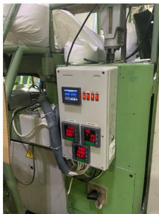
Figura 7: Sistema de monitorización
