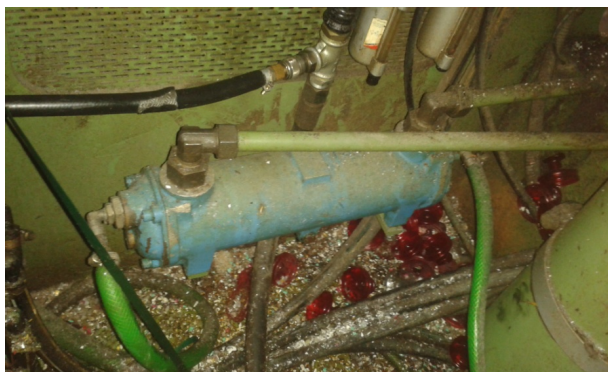
Figura 12: Intercambiador de calor
