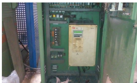
Figura 4: Vista frontal del variador de frecuencia
