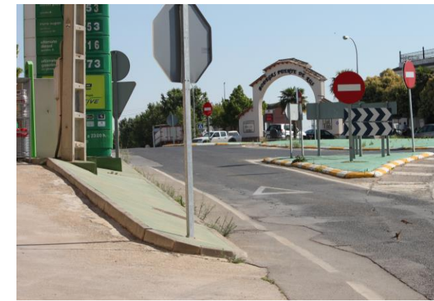
Figura 69: Marca de borde de calzada en acceso 4 a N-310
