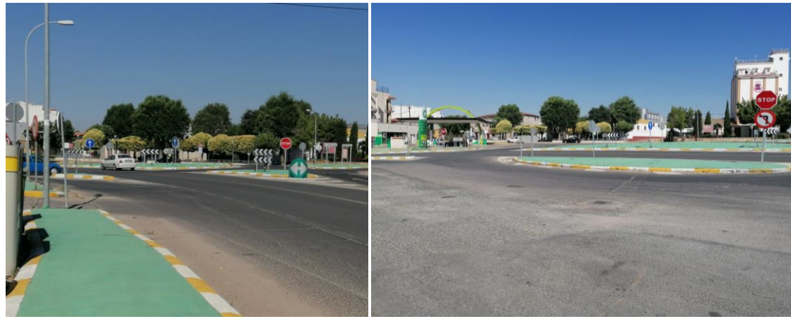
Figura 16: Señalización horizontal descolorida
