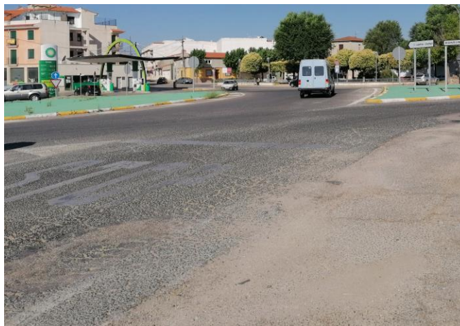
Figura 82: Línea de detención en acceso 2
