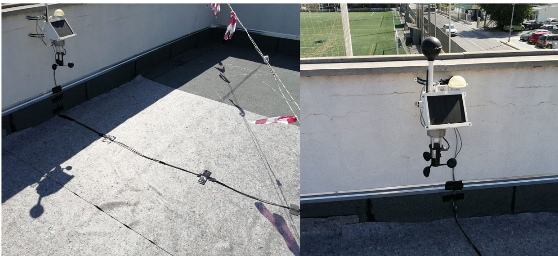
Figura 56. Transmisor HSM10 instalado.
