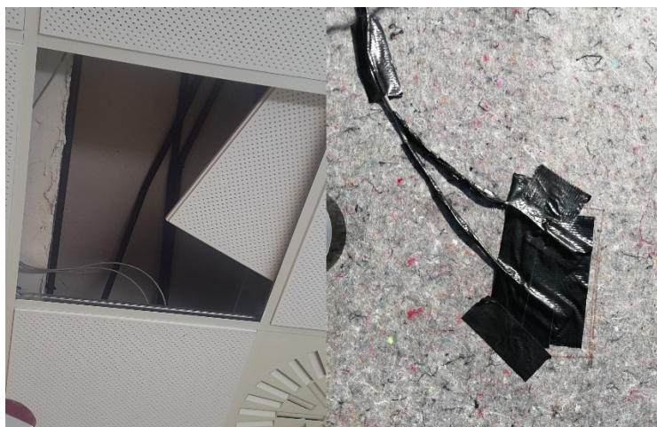
Figura 57. Instalación de sondas de temperatura en el falso techo en HSM12.
