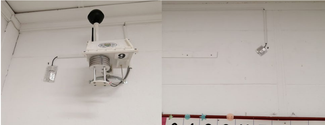
Figura 55. Transmisor HSM9 instalado.
