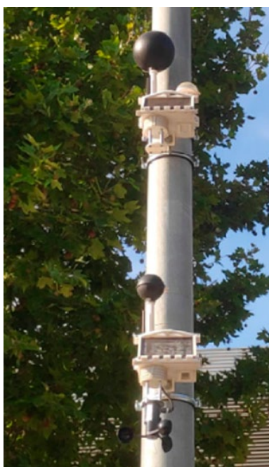
Figura 58. Transmisores HSMUPV8 y HSMUPV9 instalados.
