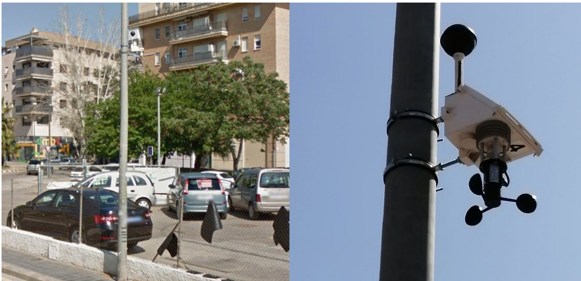
Figura 50. Transmisor HSM4 instalado.
