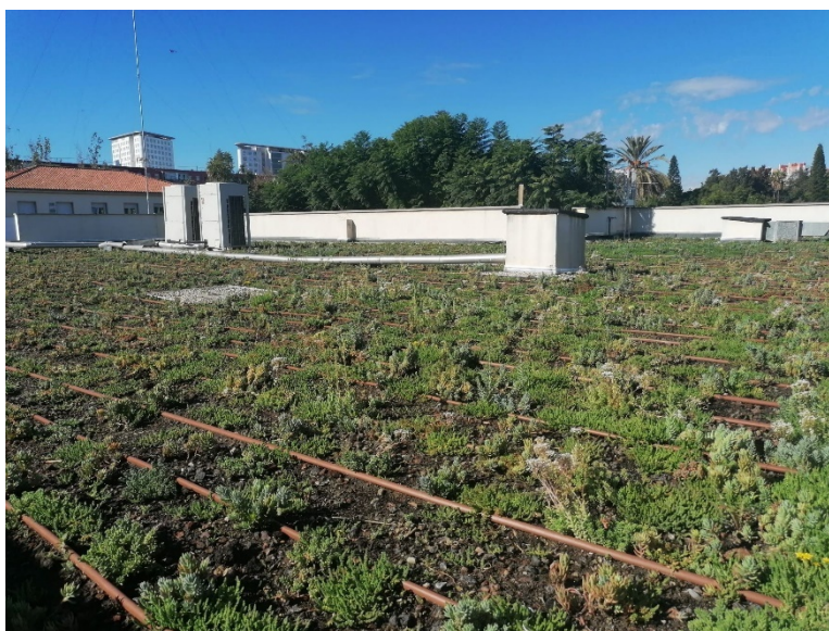
Figura 3. Cubierta ajardinada instalada en el centro de mayores de Benicalap. Fuente: growgreenproject.eu/city-actions/valencia/
