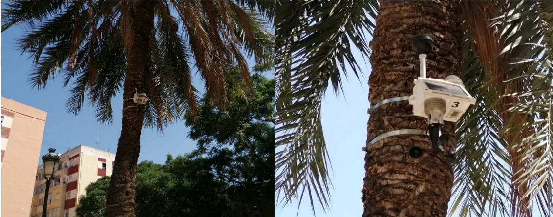
Figura 49. Transmisor HSM3 instalado.
