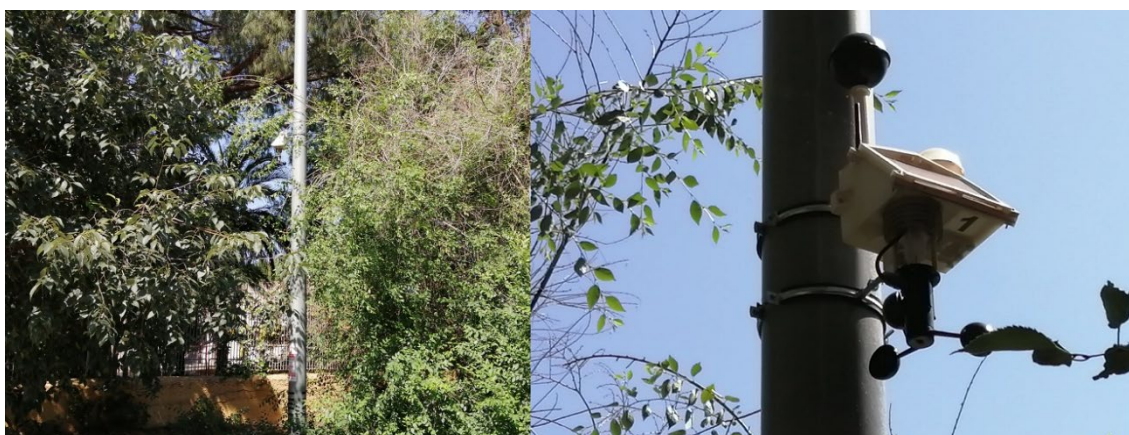
Figura 48. Transmisor HSM1 instalado.
