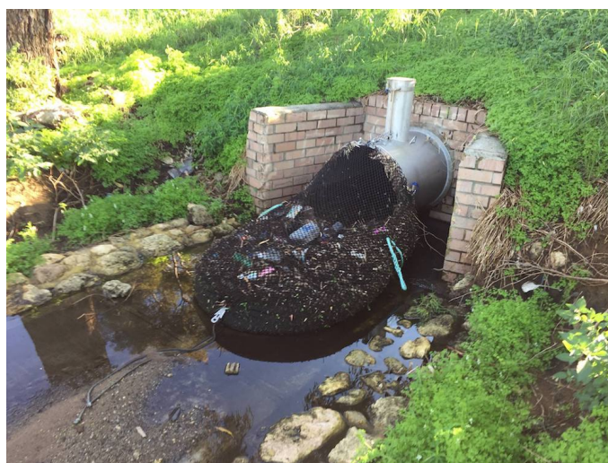
Figura 5.3. Red colocada en la boca de salida de una tubería de drenaje de la ciudad australiana de Kwinana. Fuente: Ecoinventos, 2020
