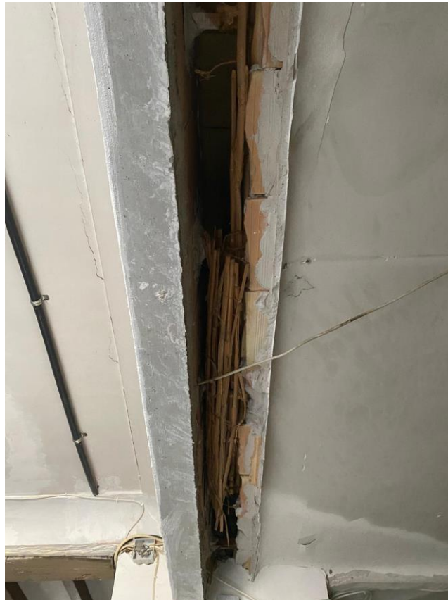
Ilustración 22. Forjado cañizo zona almacén.
