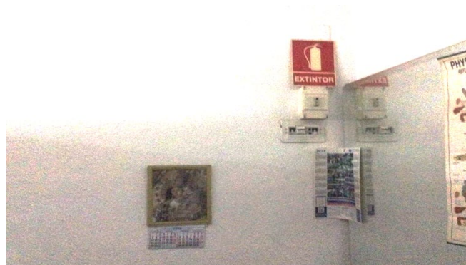
Figura 90. Interior de local actual del sistema contraincendios Fuente: Propia
