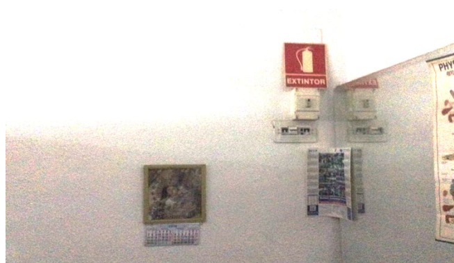
Figura 30. Fotografía del cuadro eléctrico. Fuente: Propia.
