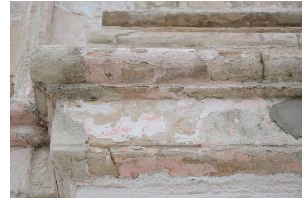
Figura 83 Superficie desconchada en una de las pilastras del Cenajus Casa de la Ciudadanía en dónde se percibe un tono rosado más intenso. Fuente: Autora (2020).
