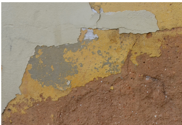
Figura 80 Distintas capas pictóricas observadas en el edificio sede de la EMGERPI. Fuente: Autora (2020).
