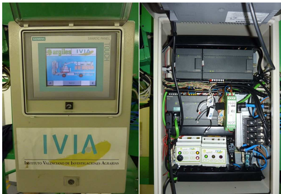
Figura I.3. Cuadro de control
