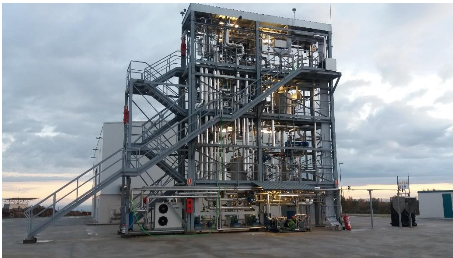
Figura 3.2. Vista posterior de la planta piloto de valorización de residuos plásticos.
