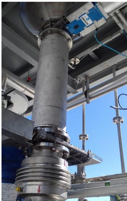
Figura 3.6. Sistema de doble válvula de guillotina para realizar la carga del fusor (F-101) desde la tolva (T-101).
