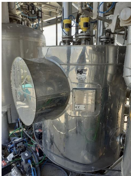
Figura 3.9. Tanque pulmón (T-201) en el que se recogen los líquidos de pirólisis condensados.
