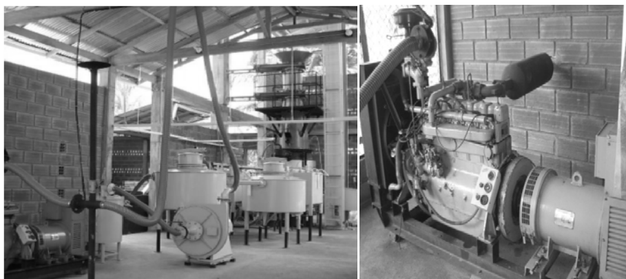
Figura 7.6. Gasificador y conjunto MCI-gasificador.
