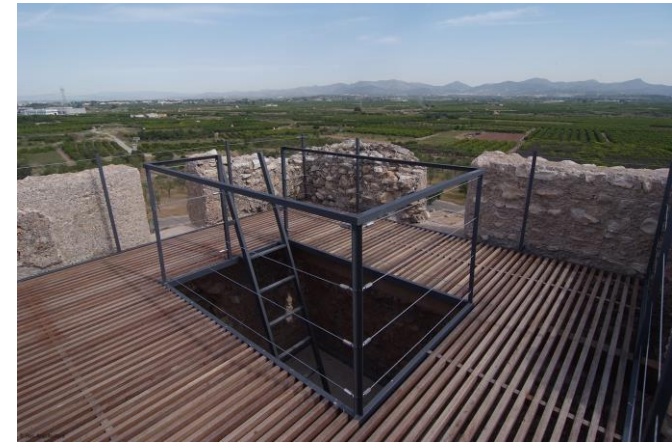
Fig 6. 25 Detall terrassa, estat actual. Mileto y Vegas, 2010
