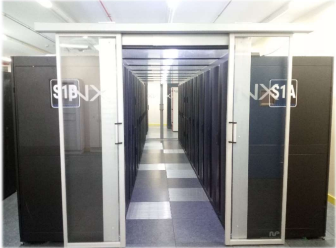
Imagen 7. Acceso pasillo frio Nixval.
