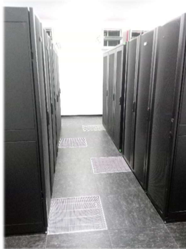
Imagen 4. Pasillo entre racks.
