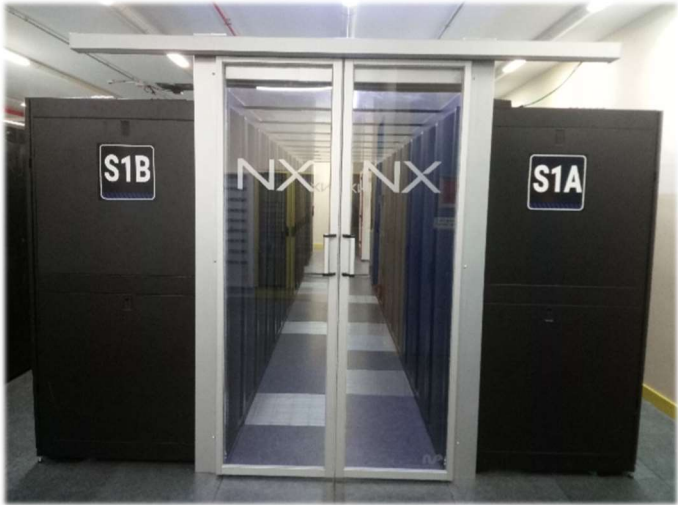
Imagen 6. Pasillo frio Nixval.
