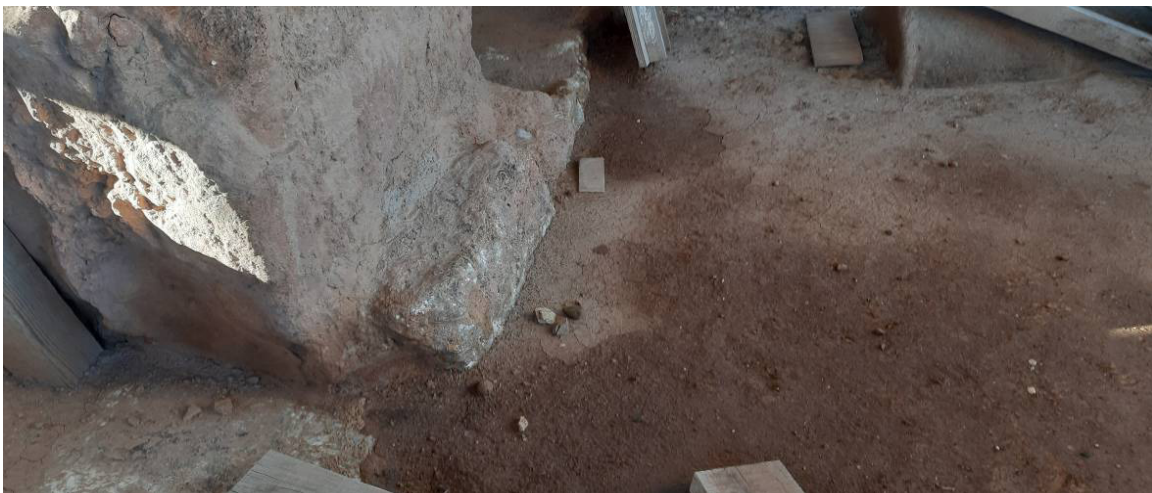
Fig. 105. En la imagen inferior podemos observar como el agua sube por capilaridad por el lateral de la fábrica, 2019.
