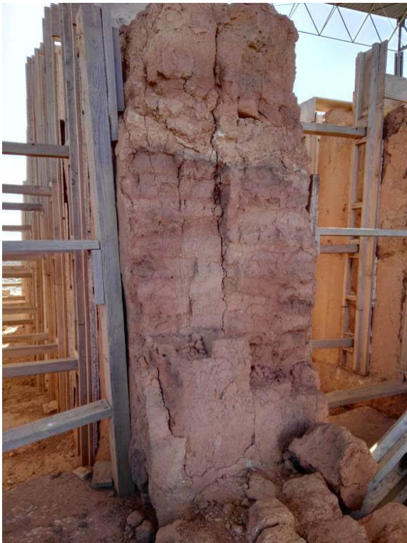
Fig. 87. Tapia 2. Vista general antes de los trabajos de consolidación, 2017.
