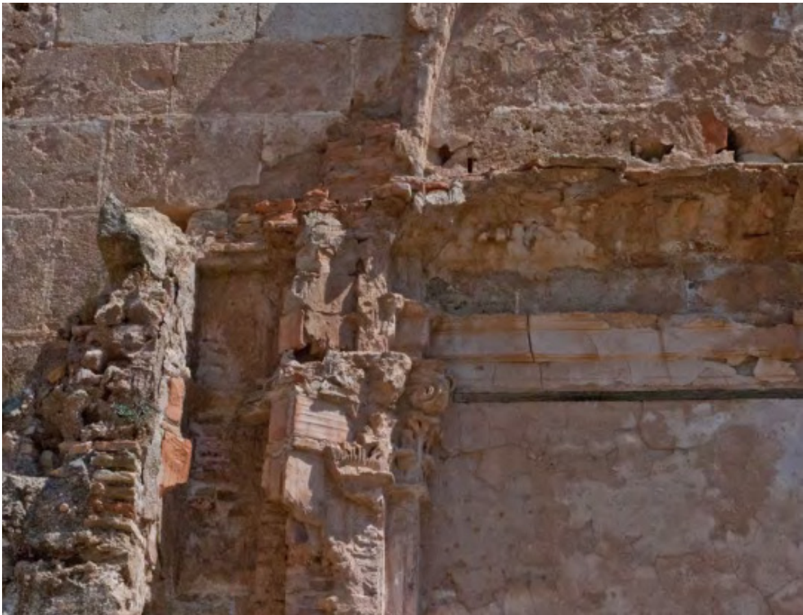
Fig. 135. Detalle del estado de conservación de las fábricas de los restos de la Capilla de Santa M. a Magdalena, 2019.
