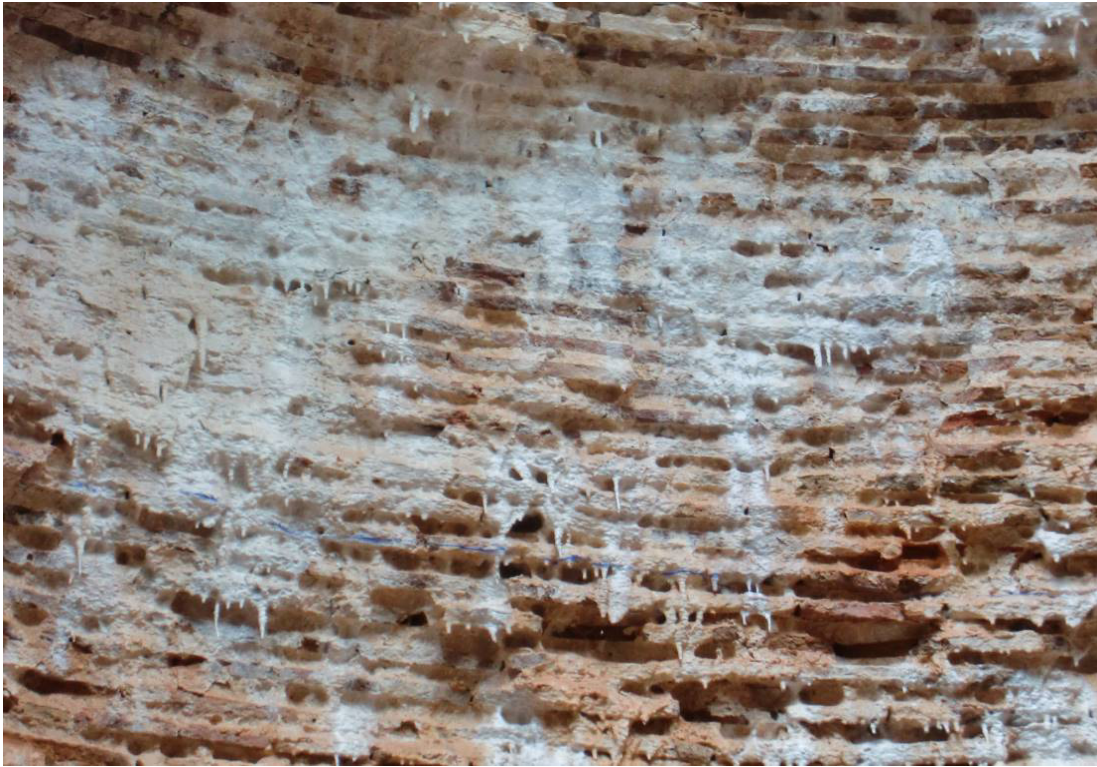
Fig. 37. Proceso de recarbonatación en el exterior de una bóveda de fábrica de ladrillo. Aljibe del castillo de Garcimuñoz.
