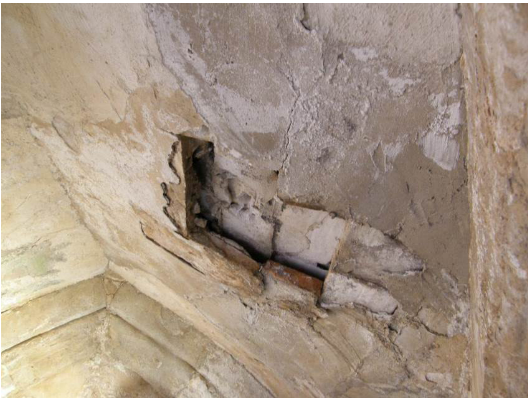
Fig. 53. Morteros de cemento en bóvedas y acumulación de sales, 2009. Fotografía de V. Torregrosa
