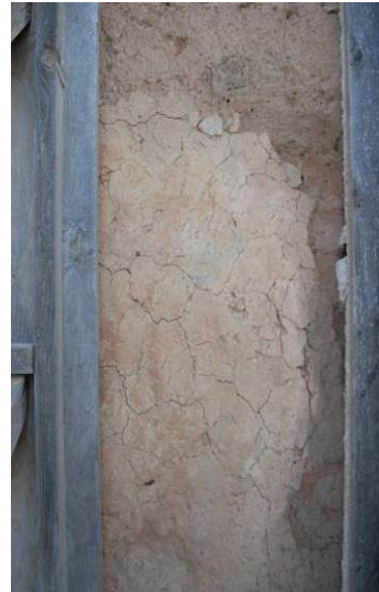
Fig. 122. Fragmento de revestimiento de cal antes de su intervención, 2017.
