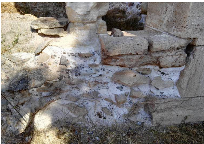
Fig. 33. Acumulación de eflorescencias salinas. Cartuja de Valdecríst, 2020. NOEMA RESTAURADORES SL
