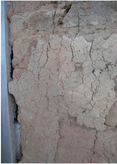
Fig. 120. Fragmento de revestimiento de cal antes de su intervención, 2017.
