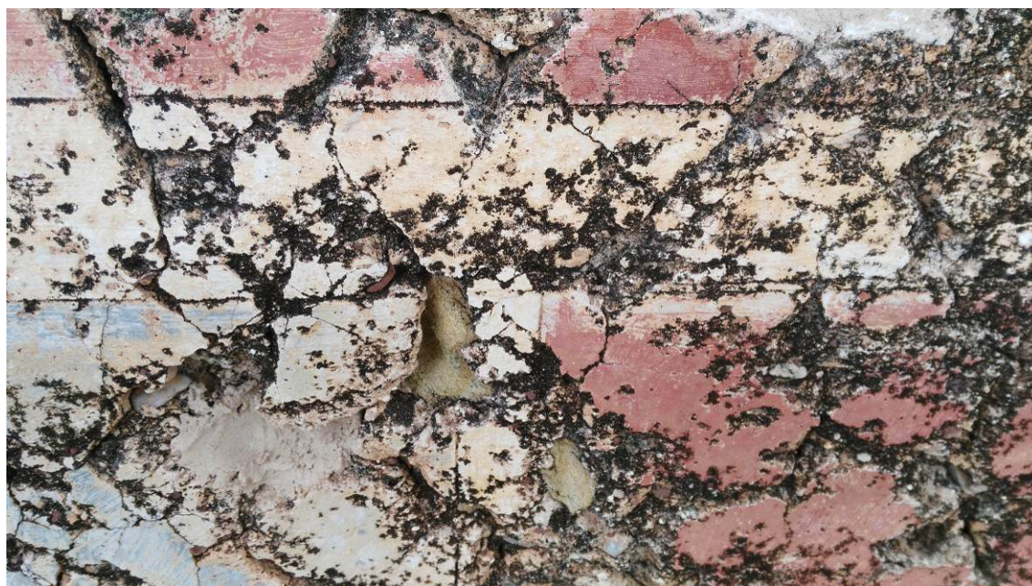
Fig. 40. Revestimiento continuo de la fachada de la Iglesia de Santiago de Benicalaf (Benavites). Proliferación de colonias bióticas que se han introducido en el interior de los bordes de las grietas del revestimiento continuo de la fachada.2016, NOEMA RESTAURADORES SL
