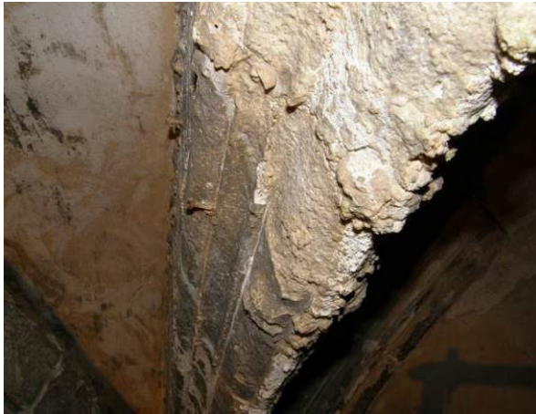
Fig. 50. Cristalización de yesos y recarbonatación del carbonato cálcico. 2009. Fotografía de Vicent Torregrosa
