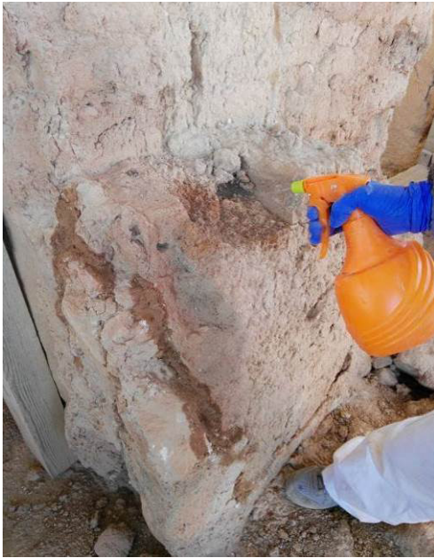
Fig. 94. Proceso de consolidación externo con la aplicación, por capilaridad, de agua de cal con una proporción previamente establecida, 2017.
