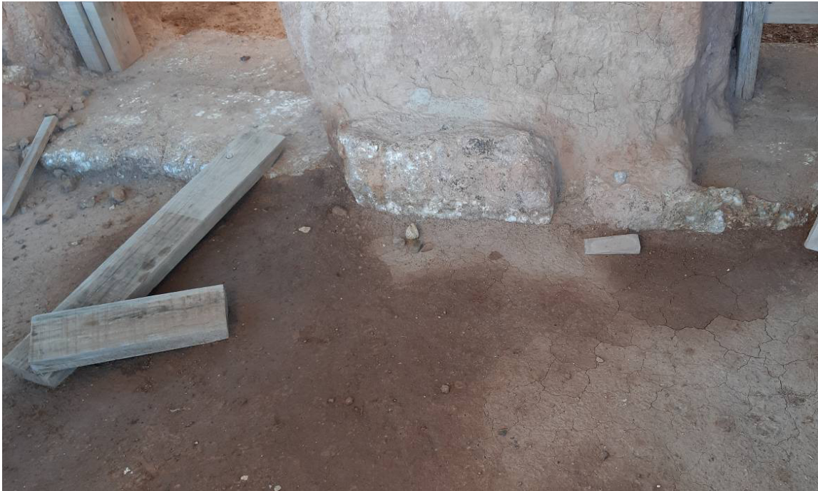
Fig. 104. Detalle de una gran acumulación de agua semanas después de las últimas lluvias y proceso de craquelado de la tierra tanto del suelo como de la parte inferior de una de las fábricas intervenidas, 2019. NOEMA RESTAURADORES
