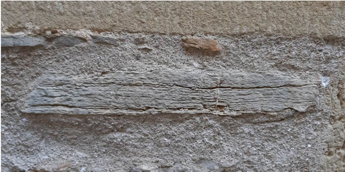
Fig. 32. ESTRIACIONES. Santuario de San Joan de Penyagolosa, 2020. NOEMA RESTAURADORES SL
