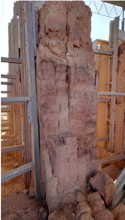
Fig. 113. Fábrica derrumbada anterior a la intervención, año 2017
