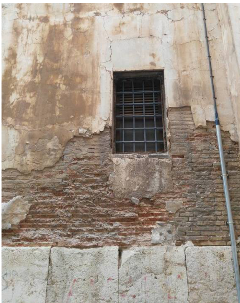
Fig. 35. Procesos de deterioro de una fábrica de ladrillo por la acción del hielo. Fachada lateral de la Catedral de Teruel, 2017. NOEMA RESTAURADORES SL.
