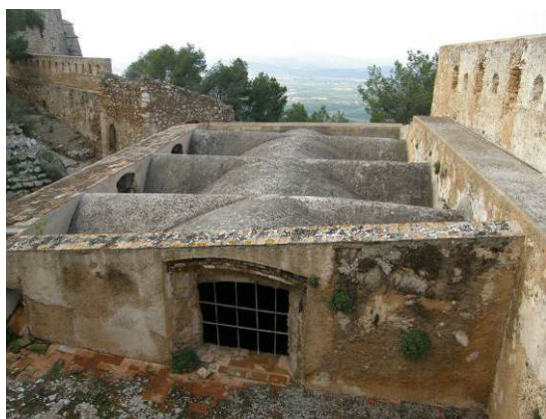
Fig. 63. Cubiertas de la capilla antes de su intervención. Foto: Vicent Torregrosa, 2009
