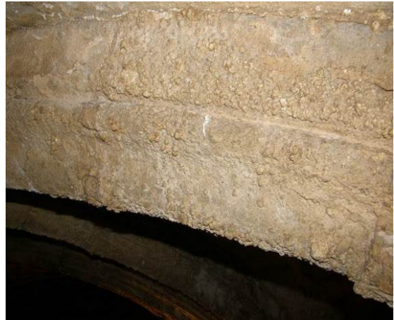
Fig. 51. Cristalización de yesos y recarbonatación del carbonato cálcico. 2009. Fotografía de V. Torregrosa
