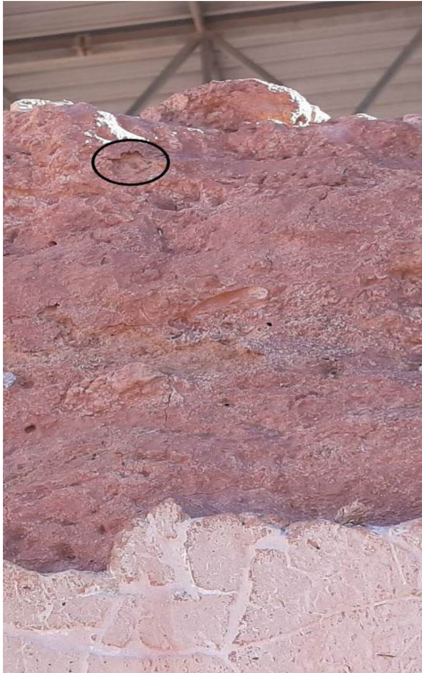
Fig. 103. Daño puntual sobre el falso revestimiento causado por la incidencia de una gotera de la cubierta, 2019. NOEMA RESTAURADORES,
