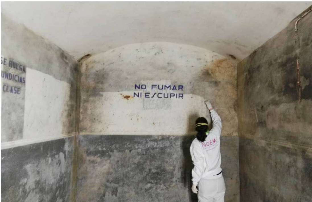
Fig. 38. Mancha de oxidación en el lateral superior derecho. Refugio antiaéreo Bombas Gens.2017, NOEMA RESTAURADORES SL.
