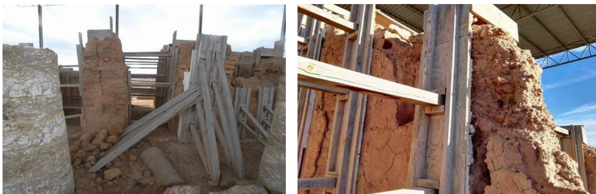
Fig. 76. A pesar de los apeos, siguen produciéndose derrumbes en las fábricas de adobe y, en algunos casos, los apeos de madera reconducen el agua por un mismo circuito y acaban causando desgastes, arrastres e importantes pérdidas de material original, 2017.
