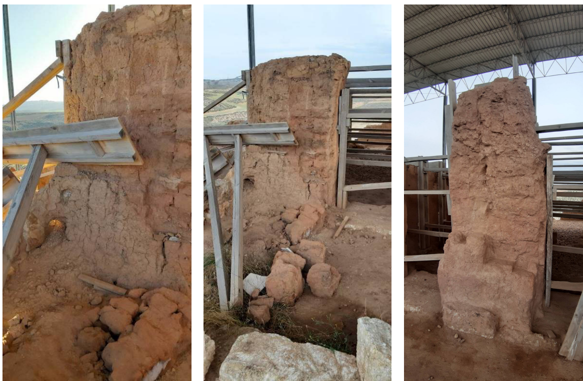
Fig. 106. Detalle de la caída de los puntales del muro del Gran edificio de adobe no intervenido provocado por la acumulación de agua y de sales en la base de la fábrica, 2019. NOEMA RESTAURADORES SL. La tercera imagen corresponde a la fábrica intervenida en 2018 y su estado en 2019. NOEMA RESTAURADORES SL.
