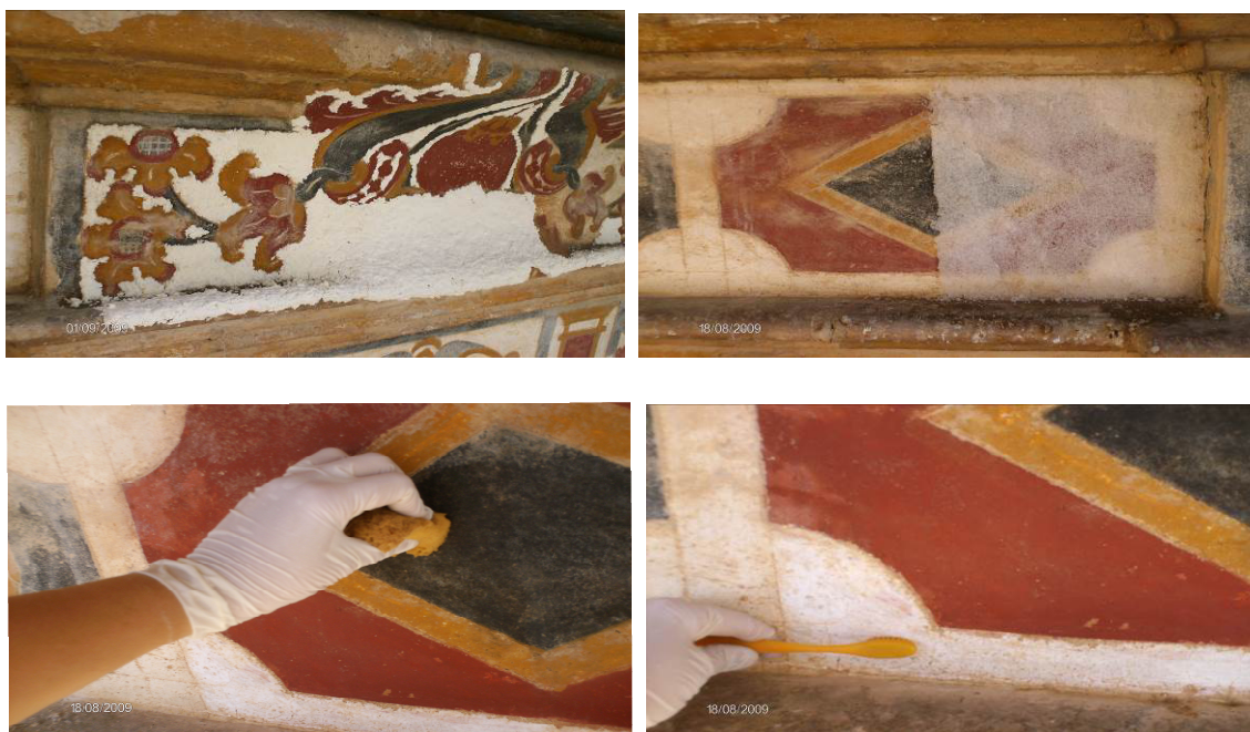
Fig. 23. Procesos de limpieza química realizados sobre los revestimientos de estuco de la fachada de las cañas del Palau Ducal de Gandia. 1. Aplicación de empacos de arbolcel y soluciones que solubilizan el estrato de deformación, 2. Aplicación de empacos de carbopool y soluciones que solubilizan el estrato de deformación, 3 y 4. Retirada de detritus con esponjas y cepillos y agua destilada, 2011. NOEMA RESTAURADORES SL.
