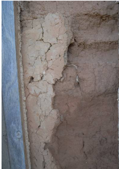
Fig. 121. Fragmento de revestimiento de cal antes de su intervención, 2017.
