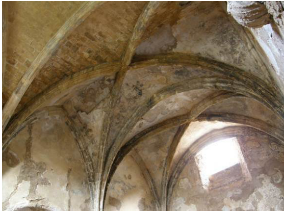
Fig. 65. Interior de la capilla antes de su restauración. Foto: Vicent Torregrosa, 2009
