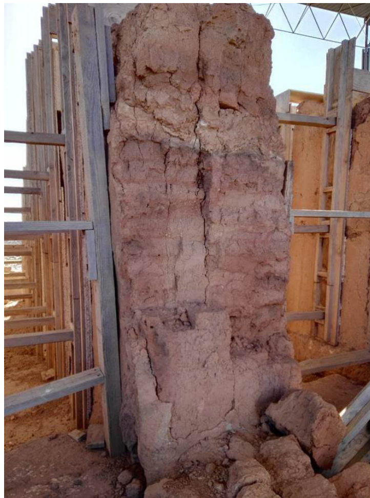
Fig. 86. Fábrica de adobe con importante derrumbe, 2017.
