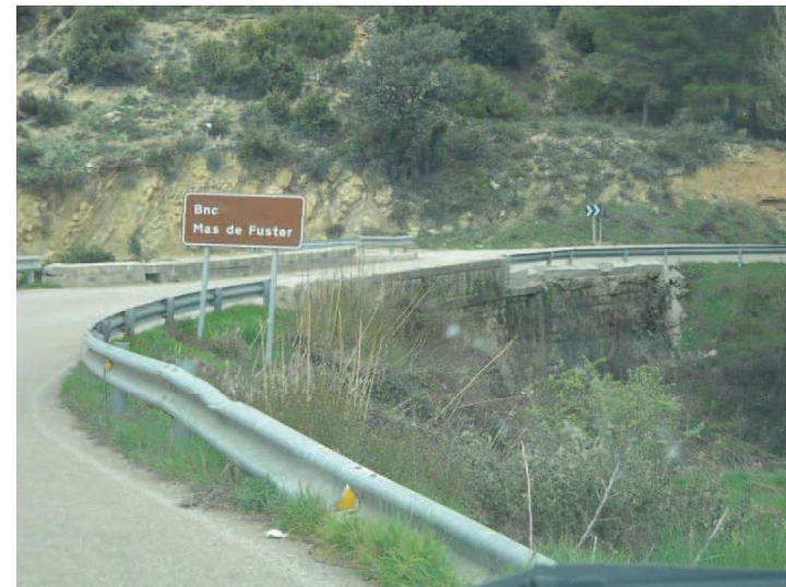
Foto nº 18: P.K. 0+600, Cambio repentino de litología
