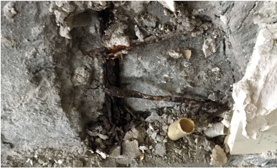
Figura 3.4 _Corrosión y pérdida de sección en armaduras de acero de los pilares.
