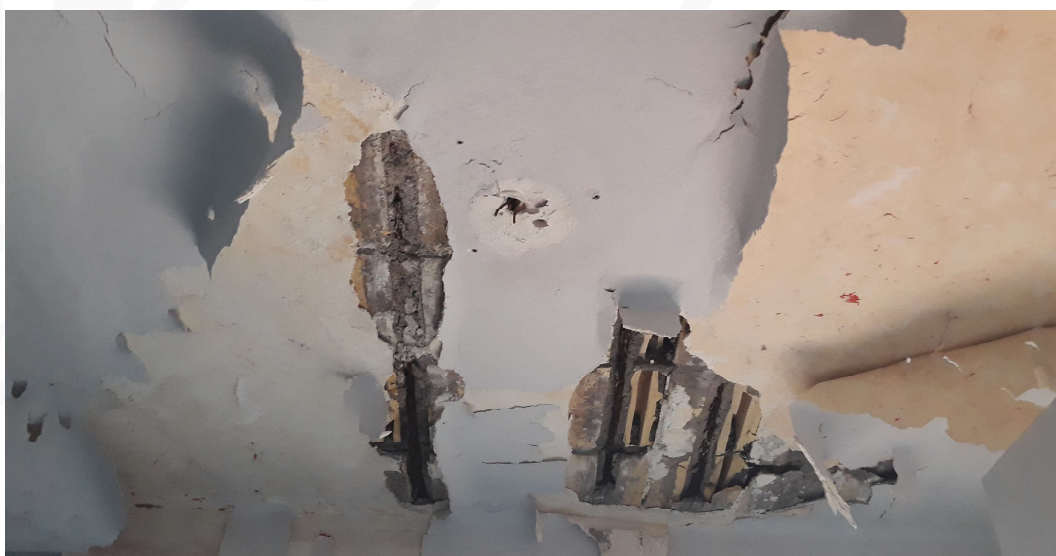
Figura 3.3 _Spalling del recubrimiento mecánico de las armaduras de acero en forjado.
