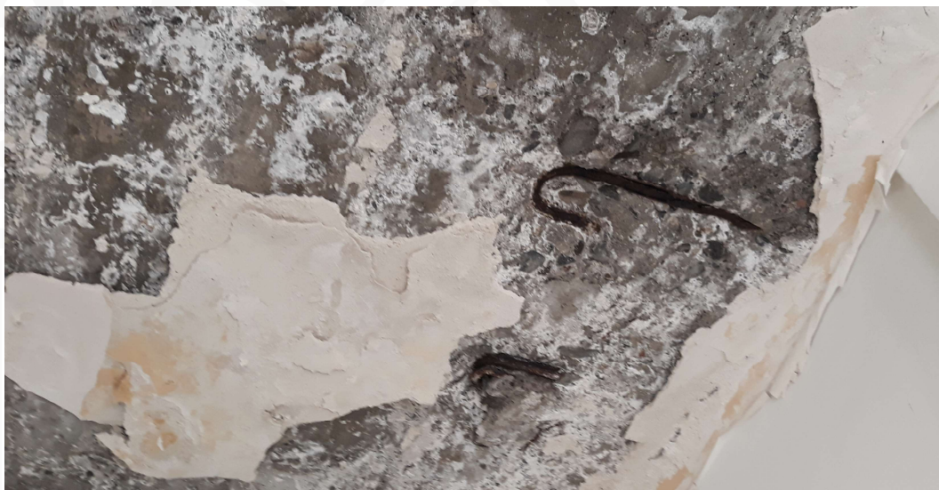
Figura 3.2 _Spalling del recubrimiento mecánico de las armaduras de acero en forjado.
