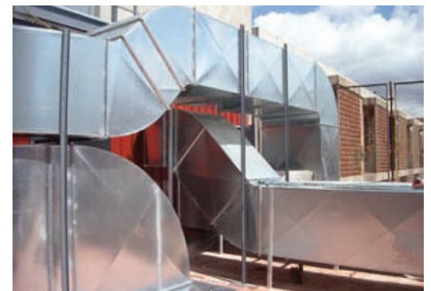
Conductos de chapa de acero galvanizado 0,8 mm con aislamiento térmico interior
