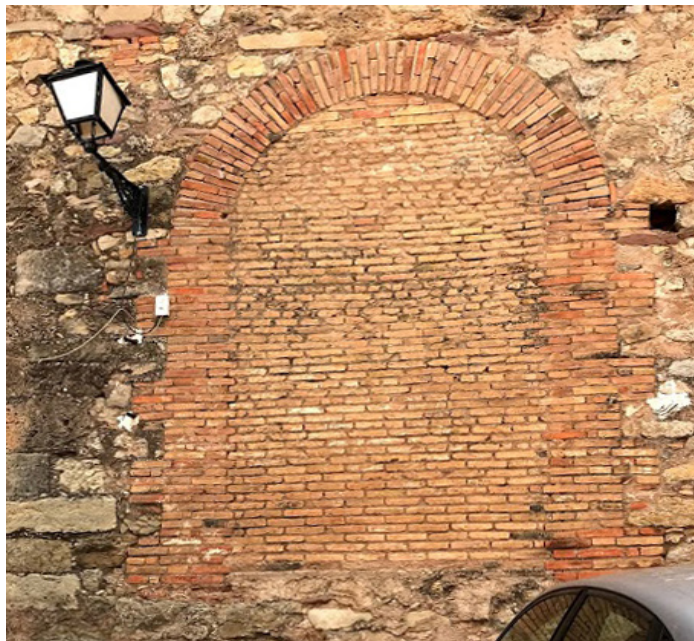
Fig.18. Puerta tapiada. Fuente: Elaboración Propia
