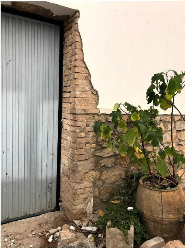
Fig.32. Muro de la vivienda descubierto en el que se puede apreciar la estructura interna. Fuente: Elaboración propia
