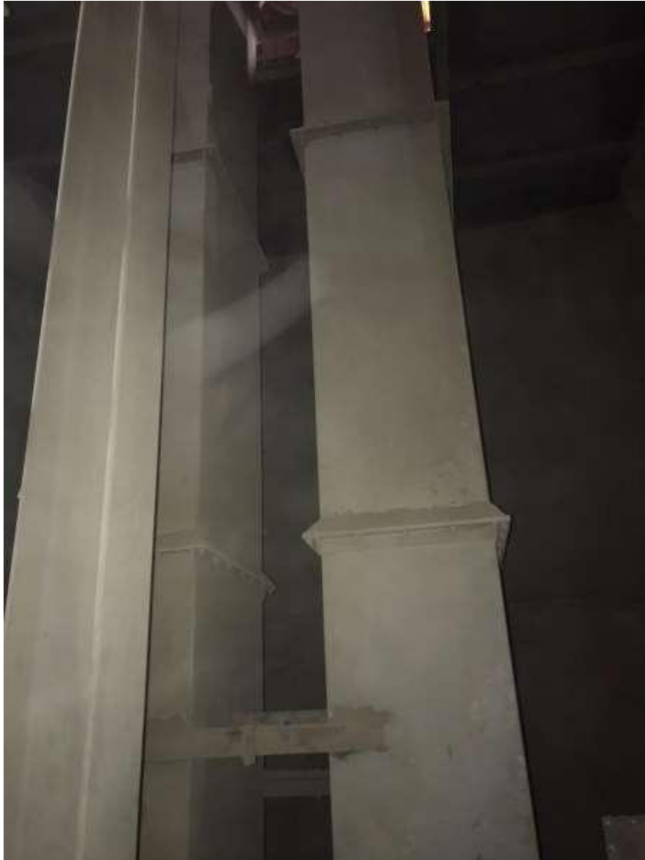
Ilustración 11. Elevador de cangilones.
