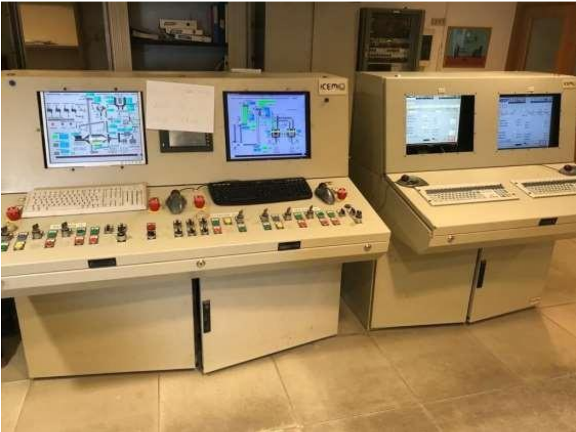
Ilustración 19. Sala de control de la planta de fabricación de Ribarroja de Túria.
