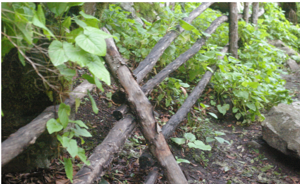
Fig. 17. Vallado caído y defectuoso.
