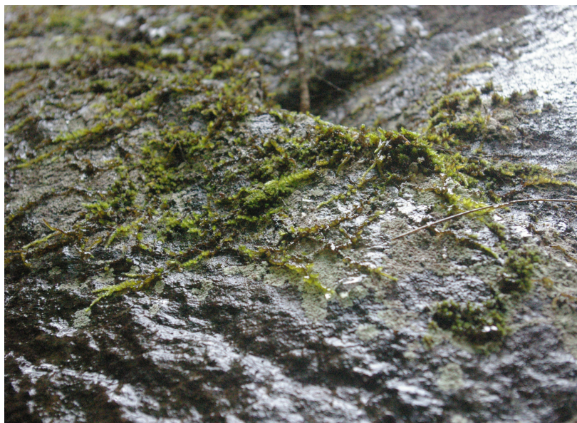
Fig. 14. Detalle de musgo depositado sobre la superficie del sustrato.
