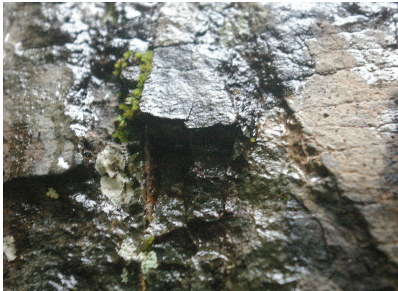
Fig. 3. Fractura y desprendimiento del soporte pétreo.
