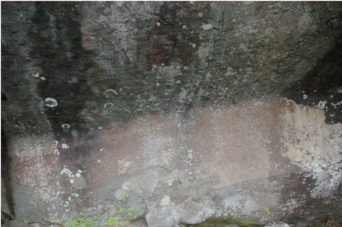
Fig. 22. Desgaste generalizado en el panel 3 correspondiente a La Zarza .
