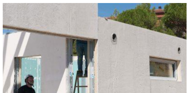
Figura 40. Colocación de un panel de hormigón prefabricado con hueco y carpintería. (Tarrés, 2017)
