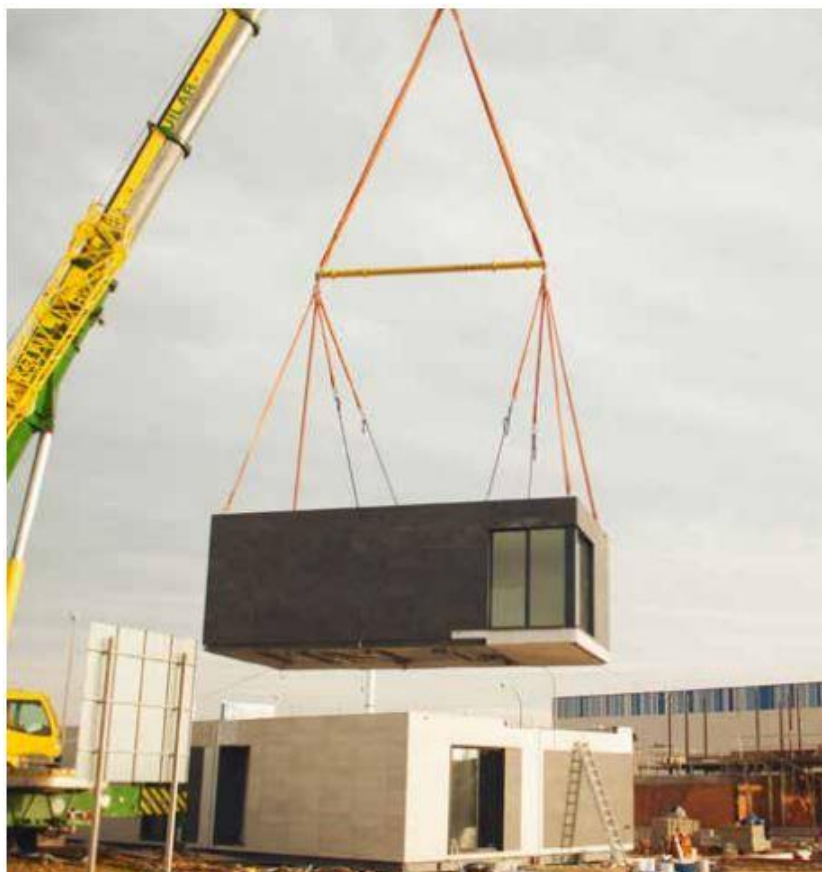
Figura 53. Colocación de módulo en una vivienda de dos alturas mediante una grúa de camión (Inhaus, 2020)
