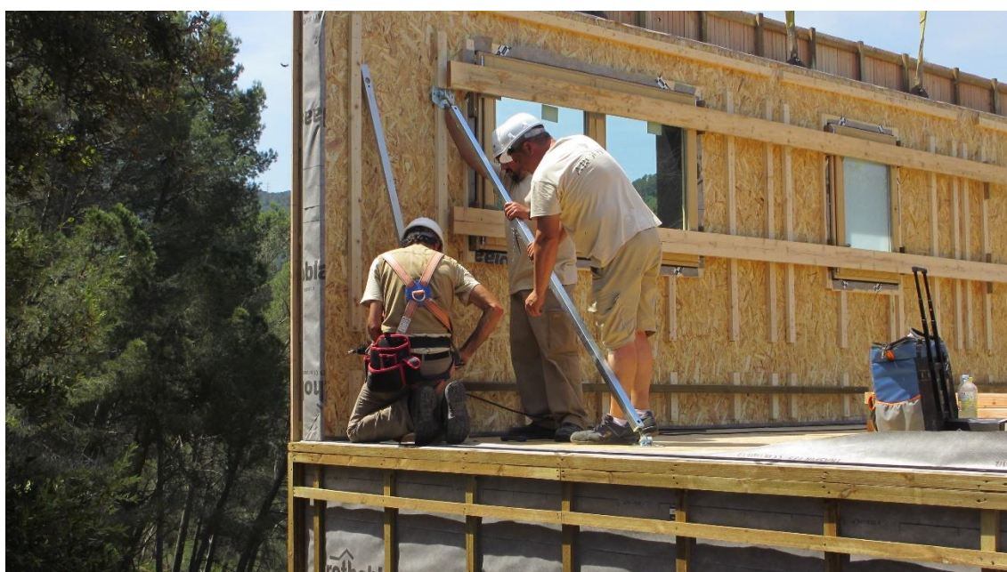
Figura 14. Montaje de una vivienda mediante entramado de madera con paneles y carpinterías incorporados en fábrica. (Cubel, 2017)
