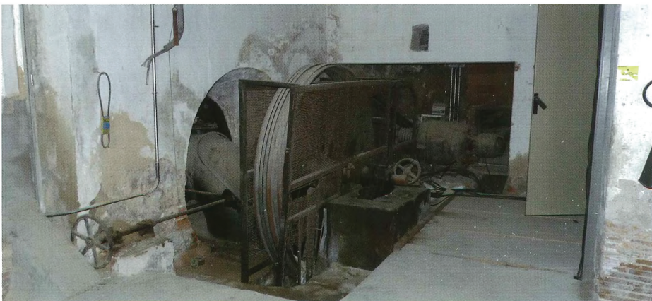
Figura 7. Turbina i alternador al complex industrial Electroquímica del Serpis el 2011. Font: Arxiu Personal de Juan Martínez Altur.
