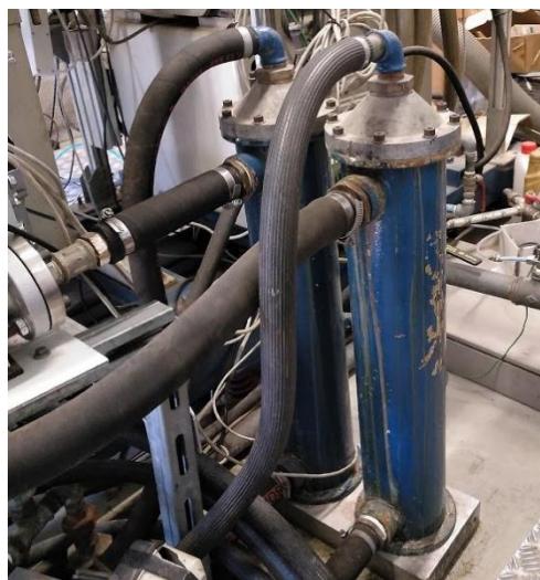
Fig. 2.2.2. Intercambiador de carcasa y tubos instalado en sala
