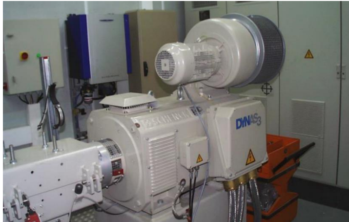
Fig. 2.2.1 Freno dinamoétrico instalado en sala
