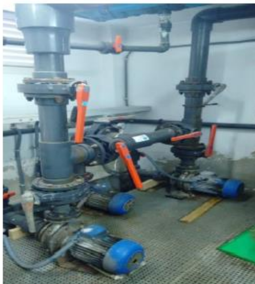
Figura 5. Sistema de bombeo.
