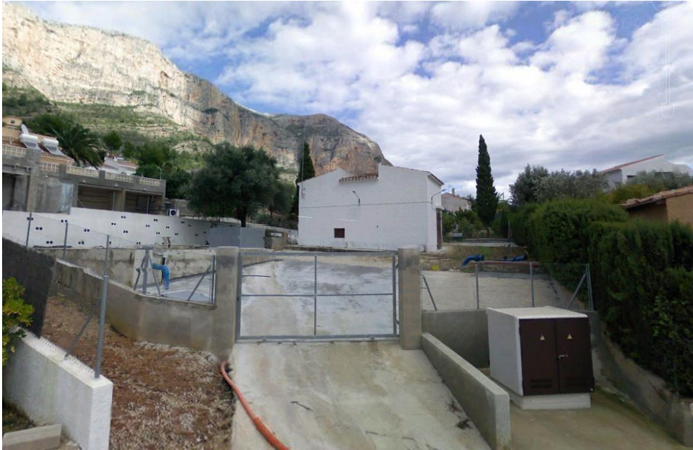
Figura 26. Estación de bombeo en la calle Acuario. Elaboración propia.
