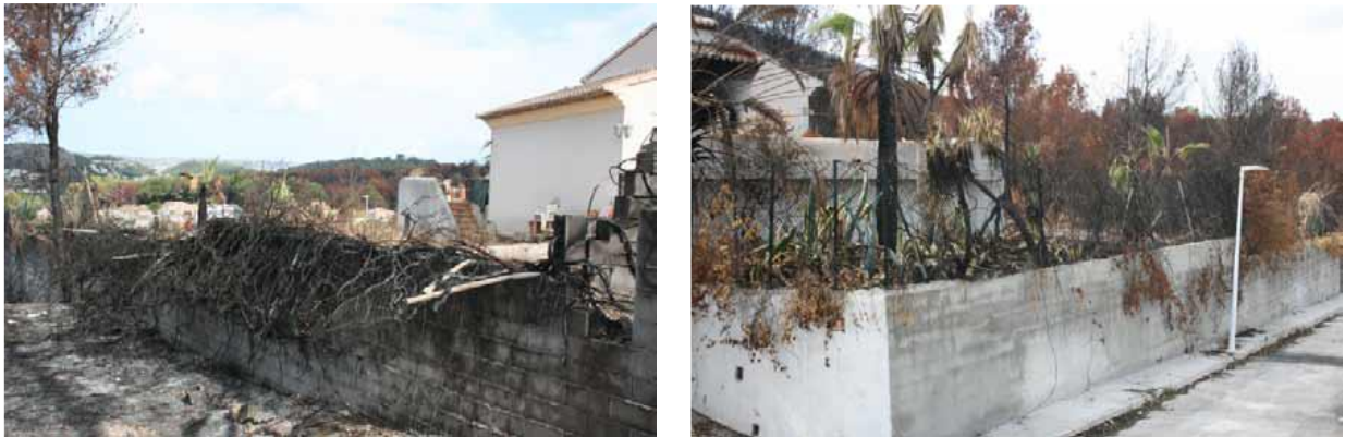
Figura 8. Estado de viviendas quemadas en la Granadella en contacto con un pinar en un bancal abandonado.
