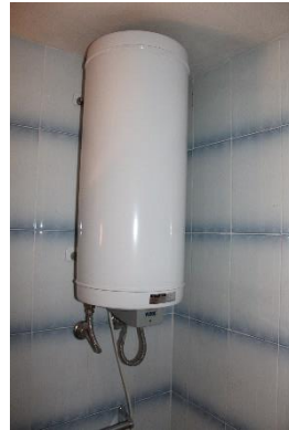
Figuras 59 y 60: Calentadores eléctricos. Año 2020. Fuente propia
