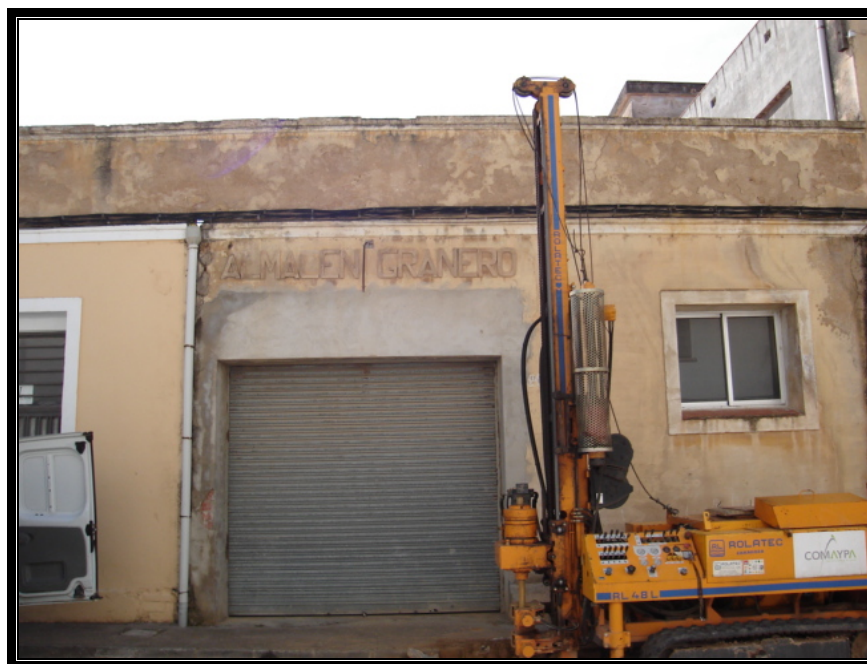
Vista del local que ocupa el solar, durante la ejecución de los trabajos de campo.
