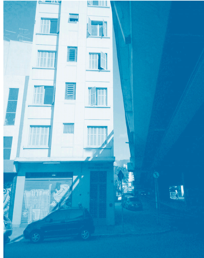
Fig. 35 Fotografía desde la parte inferior del elevado con detalle del borde. La distancia de la estructura con relación a las fachadas de los edificios al lado varían entre 3 y 5 metros.
