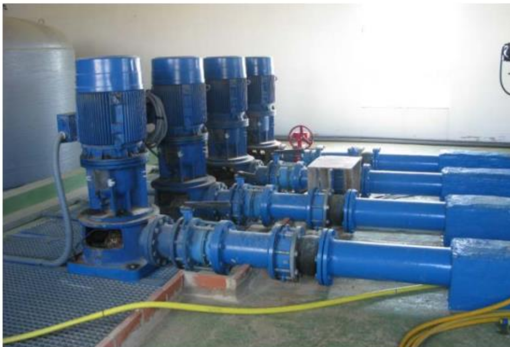
Figura 3. Bombas emplazadas en la estación de bombeo red Realón
