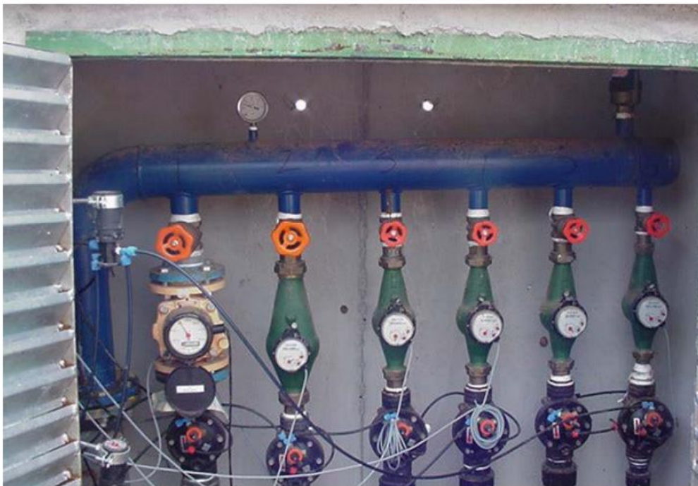
Figura 4. Detalle de los hidrantes multiusuarios
