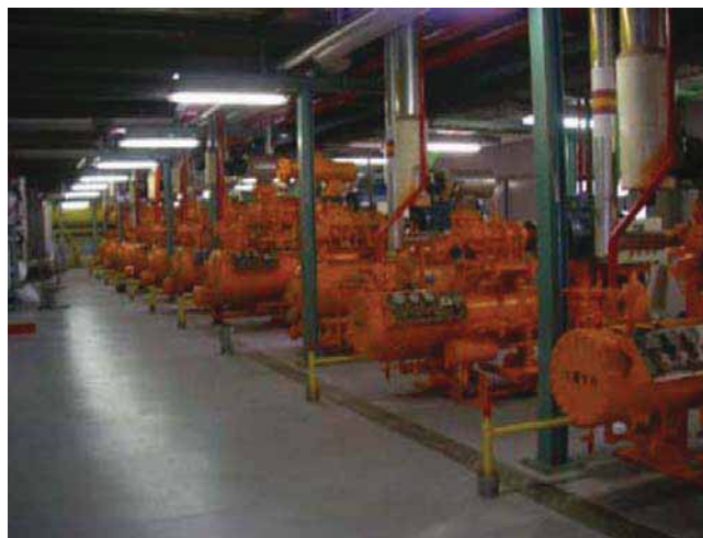
Figura 6. Detalle de planta frigorífica, zona de compresores, de la industria tratada. Fuente: Elaboración propia
