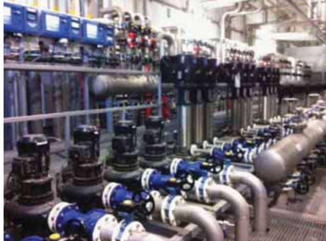
Figura 9: Detalle de salas fluidos, con sistemas de regulación mediante variadores electrónicos. Fuente: Elaboración propia.
