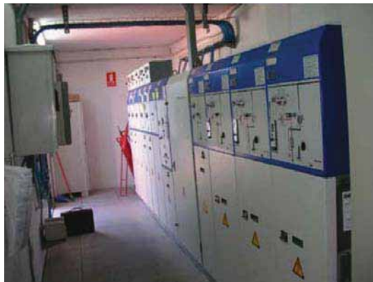
Figura 7. Zona de actuación de maniobras interruptores de alta tensión. Fuente: Elaboración propia
