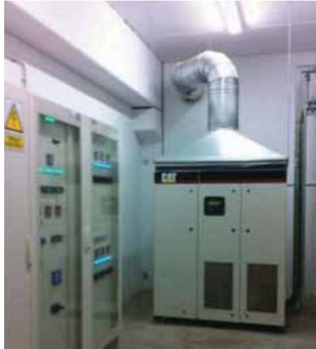
Figura 14: Detalle de sistema de alimentación ininterrumpida dinámica. Fuente: Elaboración propia.
