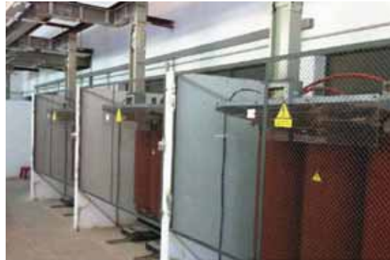
Figura 4: Detalle sistema de canalización electrificada y transformadores secos. Fuente: Elaboración propia.
