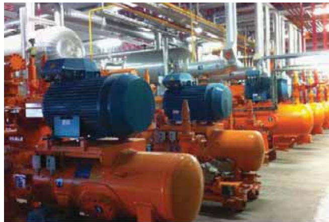
Figura 10: Detalle de sala técnica de refrigeración industrial, diseñada para las óptimas condiciones de eficiencia energética. Fuente: Elaboración propia.
