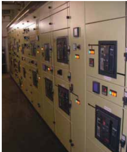
Figura 8: Detalle de sistemas de control y seguimiento en cuadros generales. Fuente: Elaboración propia.
