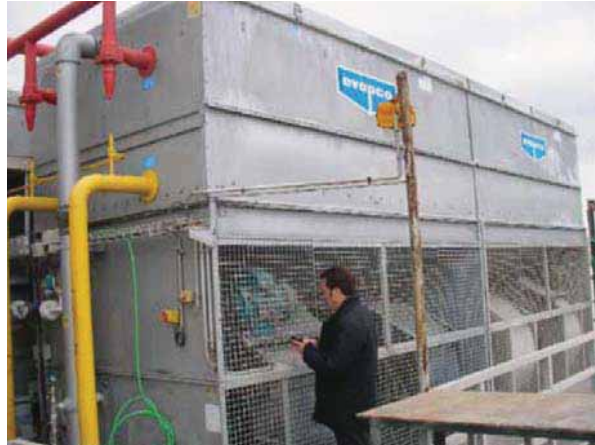
Figura 7. Detalle de planta frigorífica, zona de condensadores, de la industria tratada. Fuente: Elaboración propia
