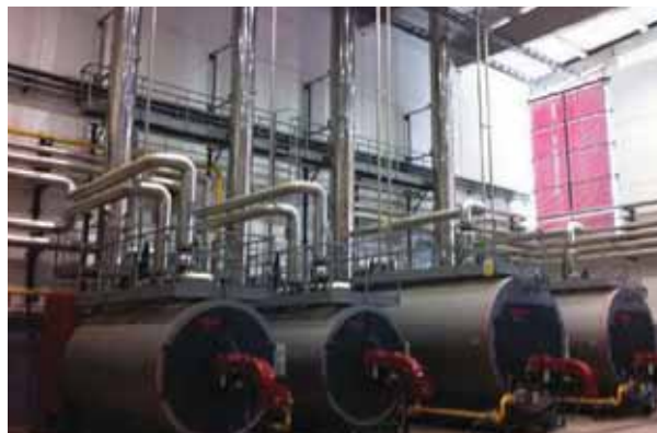
Figura 5: Detalle de sala técnica térmica de calderas, diseñada para las correctas funciones de mantenimiento. Fuente: Elaboración propia.
