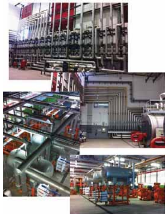
Figura 7: Detalle de salas técnica, diseñada para las correctas funciones de mantenimiento. Fuente: Elaboración propia.
