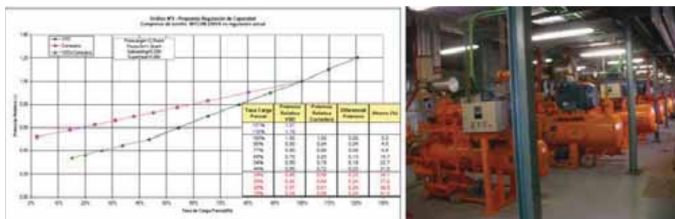
Figura 6: Gráfica operación compresor e imagen de grupos frigoríficos. Fuente: elaboración propia.
