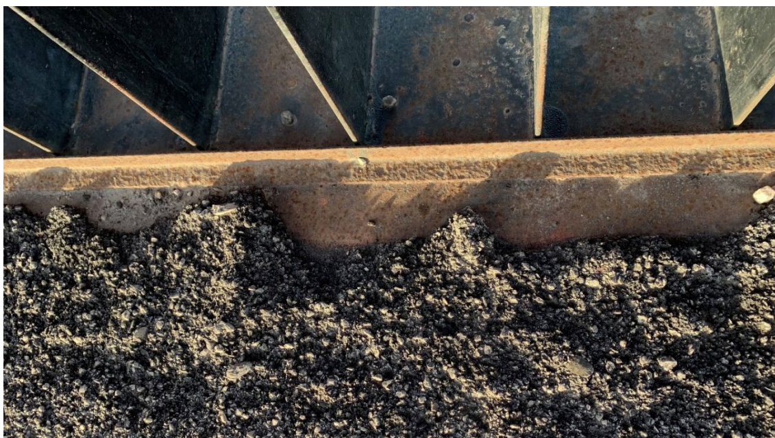
Imagen 55 Huecos existentes en el pavimento. (Fuente: elaboración propia).
