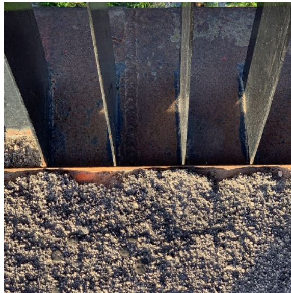
Imagen 8 estado del pavimento. (Fuente: elaboración propia)
