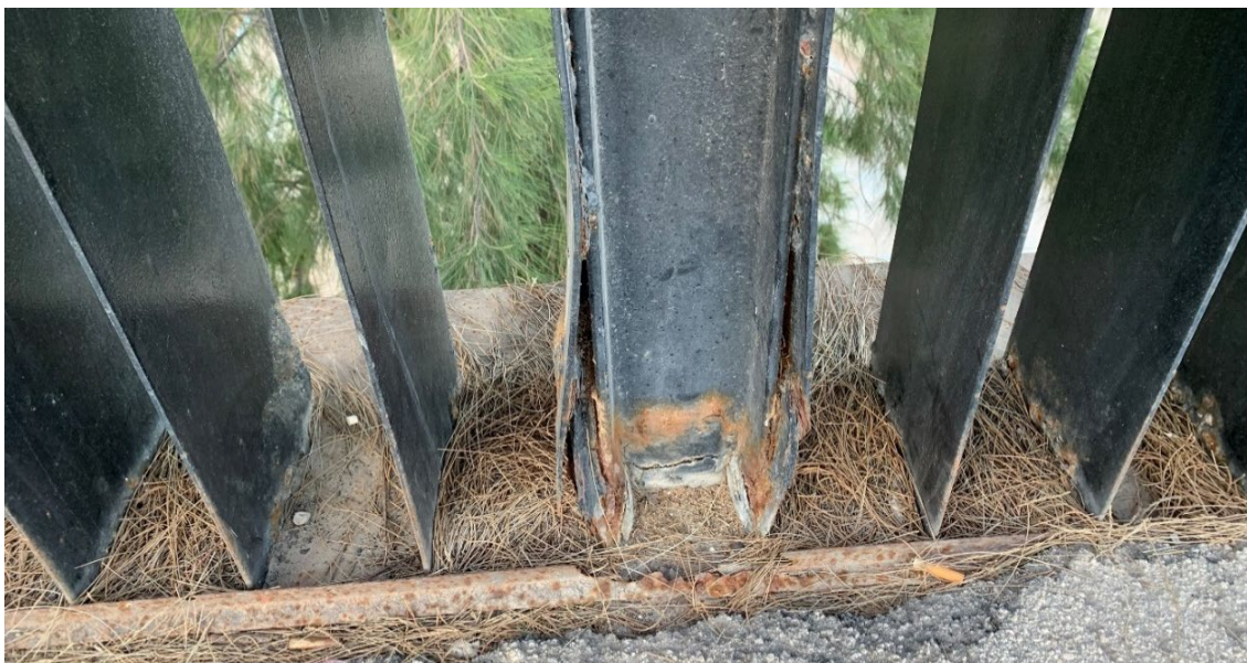
Imagen 51 Estado de deterioro de algunos montantes y lamas de la barandilla. (Fuente: elaboración propia).
