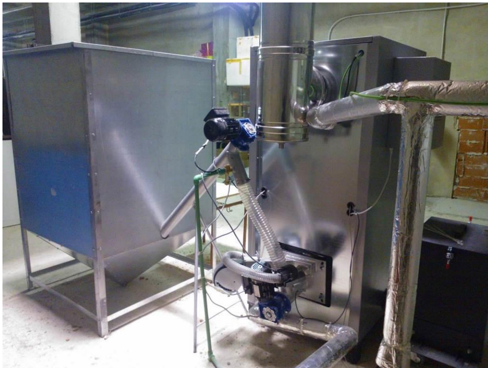
Fotografía 54. Caldera de biomasa poli combustible de 65 kW del edificio consistorial, parte trasera. Fuente: Elaboración propia
