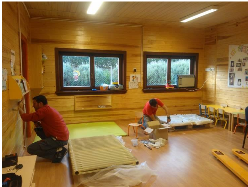
Fotografía 44. Instalación de radiadores y circuito de agua caliente en la Guardería municipal.
