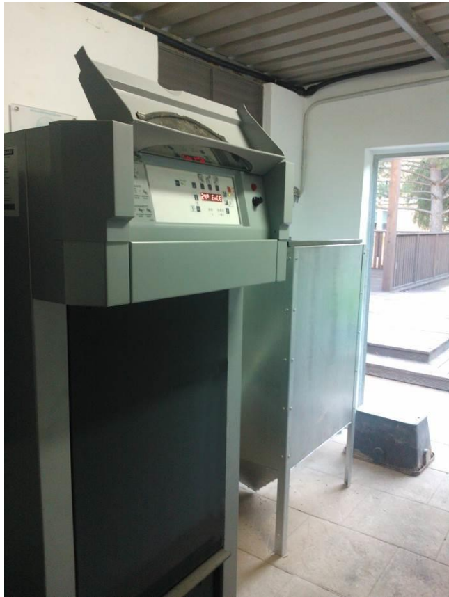
Fotografía 38. Caldera de biomasa y silo de la instalación de calefacción de la guardería.
