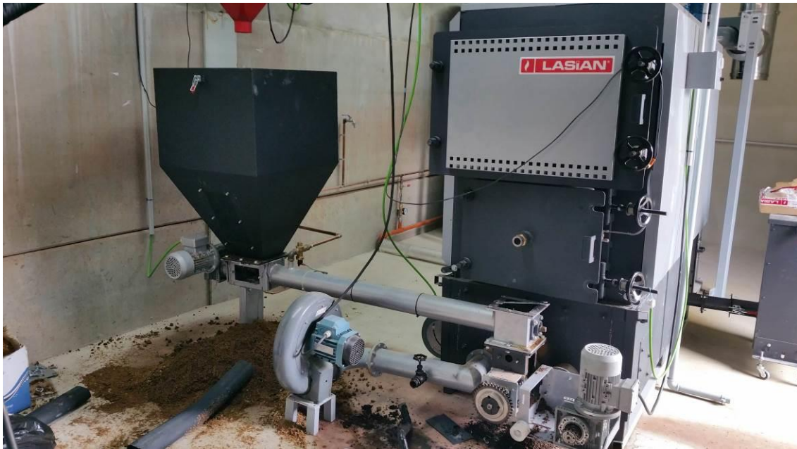
Fotografía 72. Desmontaje del transporte de combustible por salto de la válvula de seguridad.
