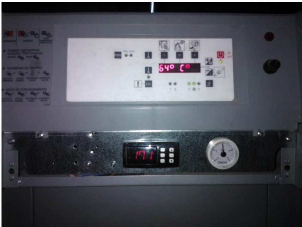
Fotografía 60. Cuadro de mando de la caldera del ayuntamiento en funcionamiento.
