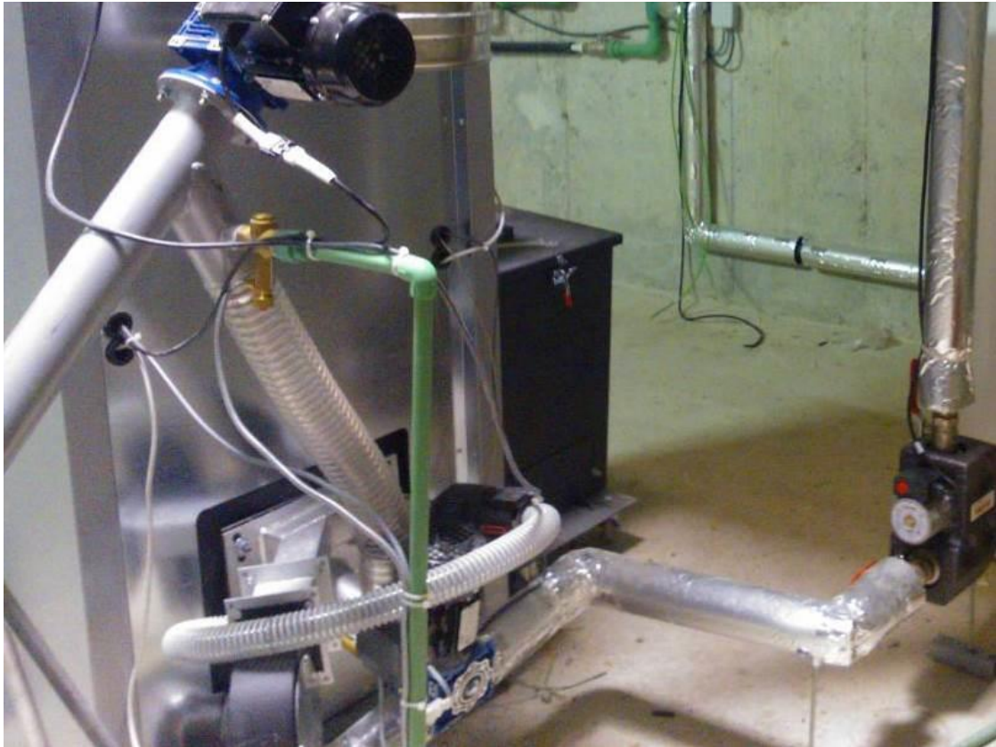
Fotografía 26. Parte trasera de la caldera donde se aprecian los conductos de transporte del combustible.
