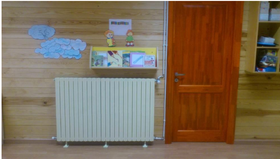
Fotografía 49. Instalación de radiadores y circuito de agua caliente en la Guardería municipal. Fuente: Elaboración propia
