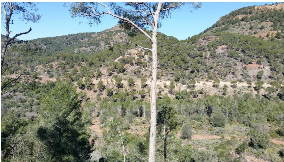
Fotografía 79 .Trabajos de ejecución del área cortafuegos camino Ombría Castell. Fuente: Elaboración propia.
