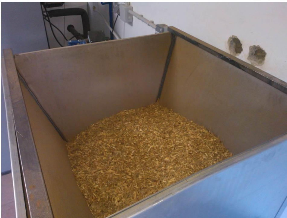
Fotografía 43. Silo de la caldera de la guardería con astilla como combustible.
