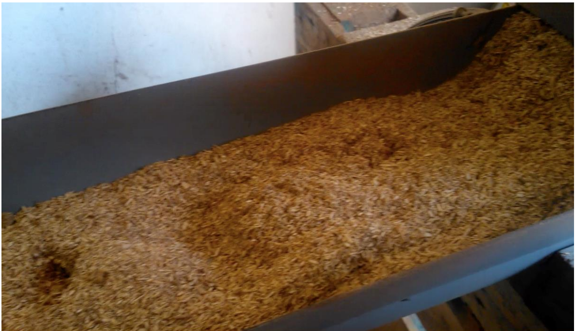
Fotografía 13. Tornillo sinfín a continuación de la tolva acoplada a la peletizadora de 15 kW en funcionamiento.
