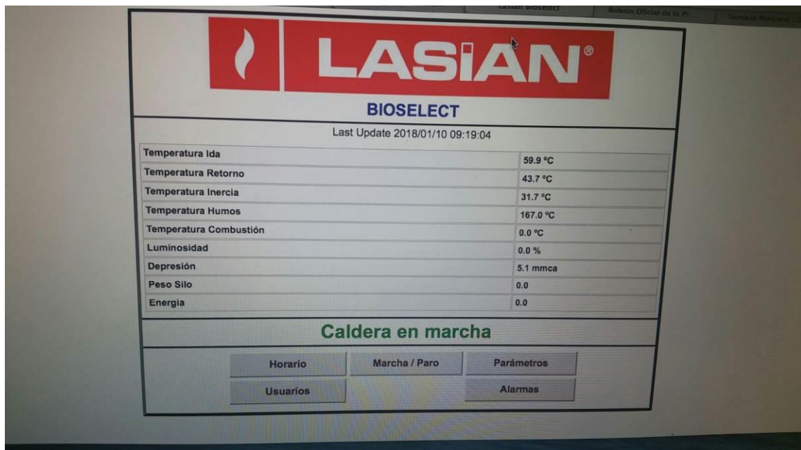
Fotografía 62. Interfaz de control remoto de la caldera del colegio público en terminal informático.
