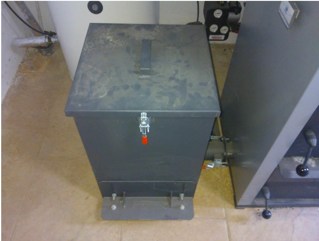
Fotografía 40. Depósito de acumulación de cenizas junto a la caldera de la guardería.
