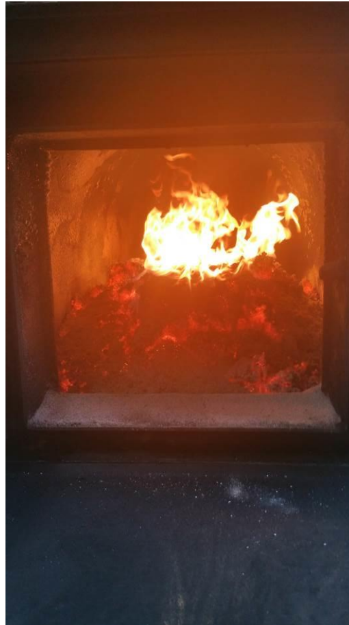
Fotografía 71. Quemador de la caldera del colegio público.
