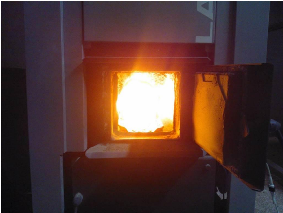
Fotografía 59. Quemador de la caldera del ayuntamiento en funcionamiento.
