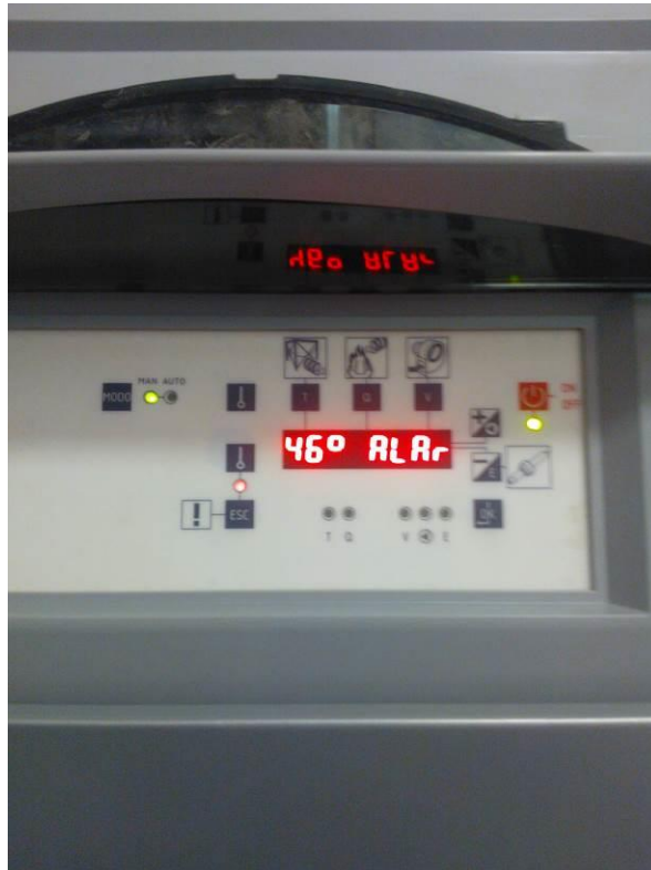
Fotografía 42. Cuadro de mandos de la caldera de la guardería que muestra la caldera en alarma por falta de combustible.
