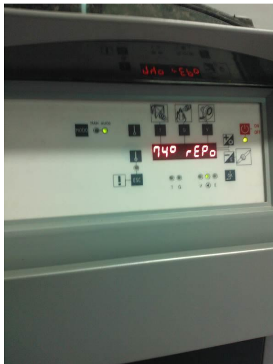
Fotografía 41. Cuadro de mandos de la caldera de la guardería que muestra la caldera en funcionamiento a 74° C.
