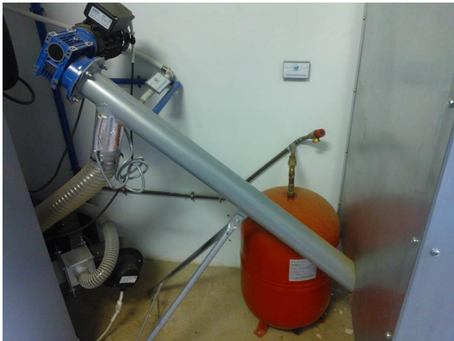
Fotografía 39. Tornillo sinfín de transporte del combustible del silo a la caldera de la guardería.
