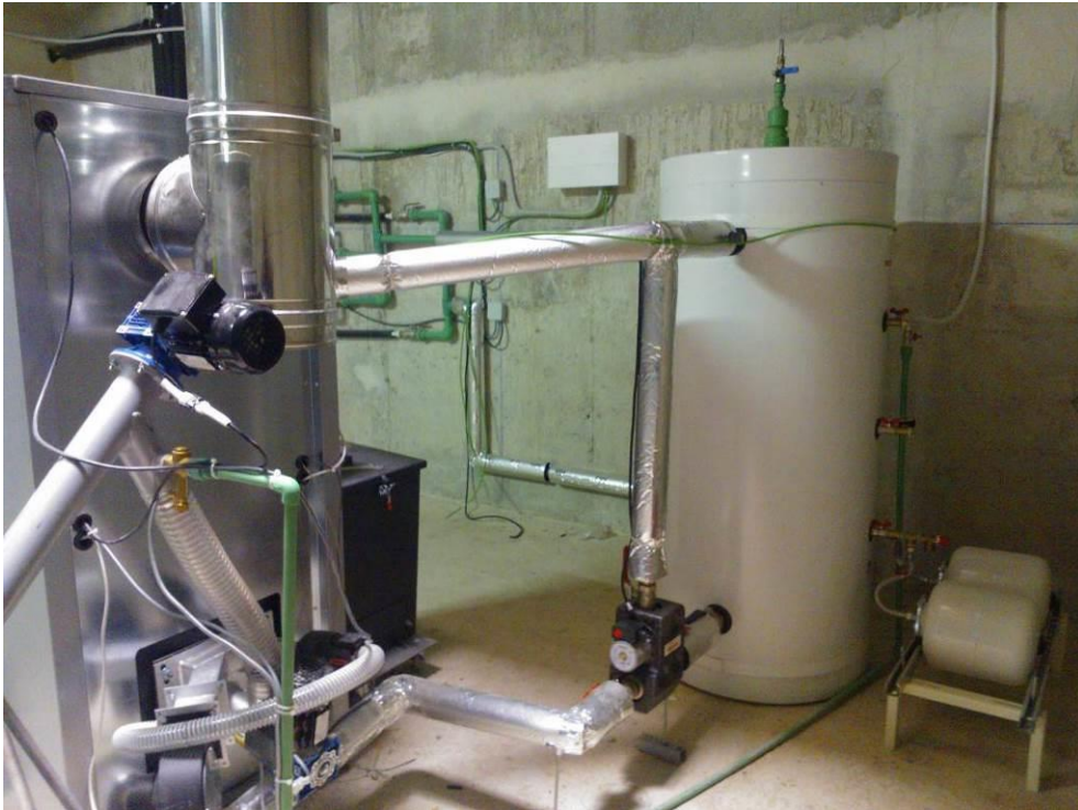
Fotografía 55. Caldera de biomasa poli combustible de 65 kW del edificio consistorial, parte trasera. Fuente: Elaboración propia
