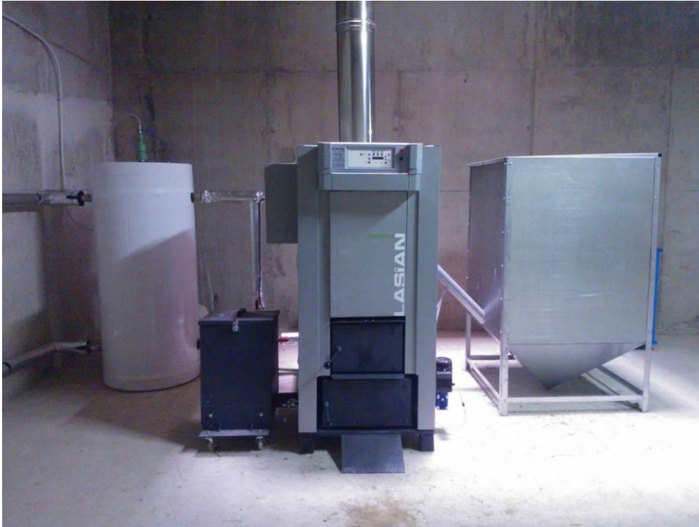
Fotografía 51. Caldera de biomasa poli combustible de 65 kW del edificio consistorial. Fuente: Elaboración propia
