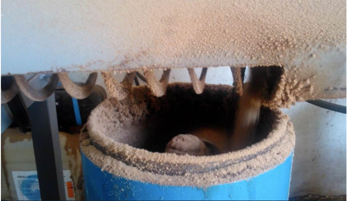
Fotografía 14. Tornillo sinfín a continuación de la tolva y descarga en la peletizadora de 15 kW en funcionamiento.
