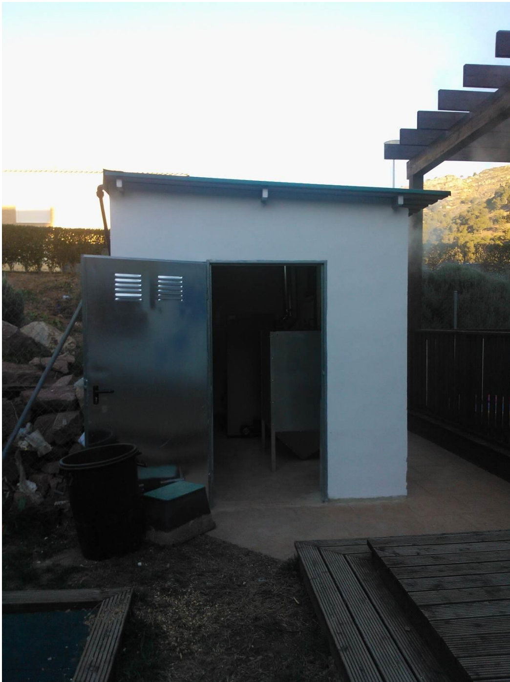
Fotografía 37. Caseta exterior junto al edificio de la guardería que aloja la caldera de biomasa.
