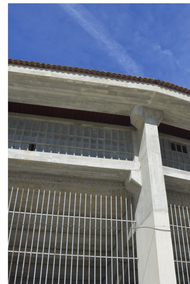
Figura 109. Exterior de la tribuna Gol Sur, donde se aprecia la curvatura y la losa de hormigón superior al pórtico, 2020.
