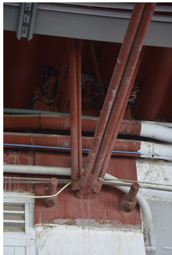
Figura 112. Empotramiento de las celosías inferiores de la cubierta sobre la tribuna Preferente con el soporte, 2020.
