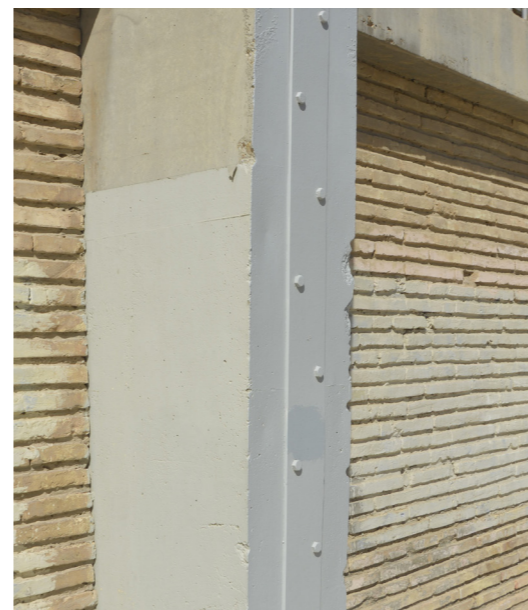
Figura 122. Refuerzos metálicos en las caras exteriores de los soportes de la tribuna General, 2020.
