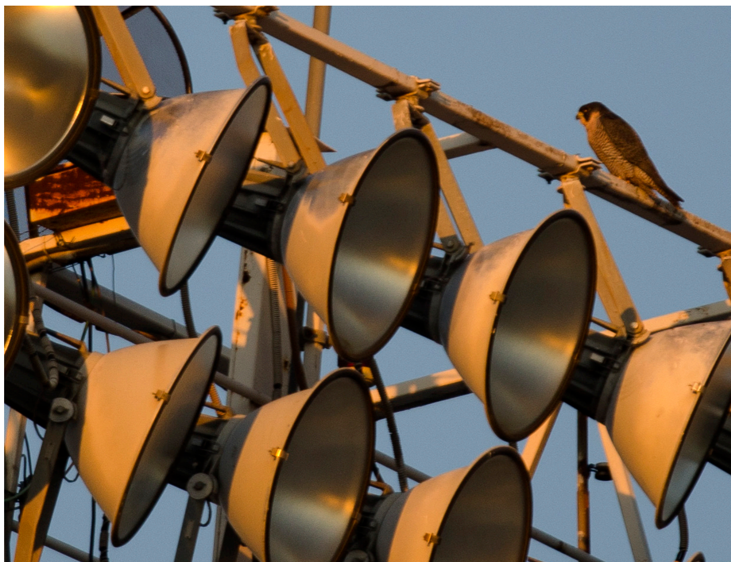
Figura 99. Focos de iluminación en la parte superior de la torre.
