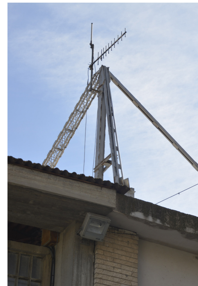
Figura 113. Unión de la celosía superior con la estructura auxiliar que conecta con la coronación del soporte del pórtico, 2020.
