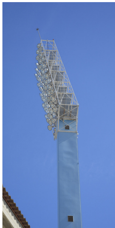
Figura 43. Torre de iluminación. 2020.
