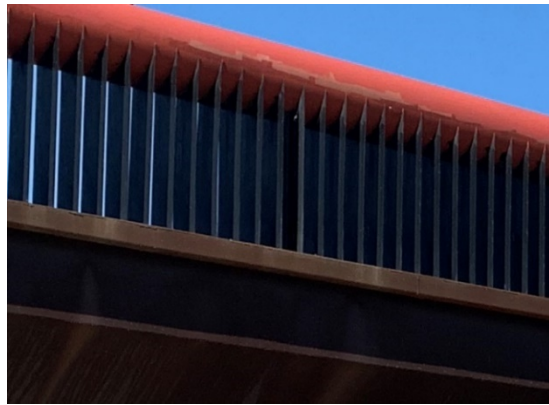
Imagen 9 Imposta y barandilla. (Fuente: elaboración propia)
