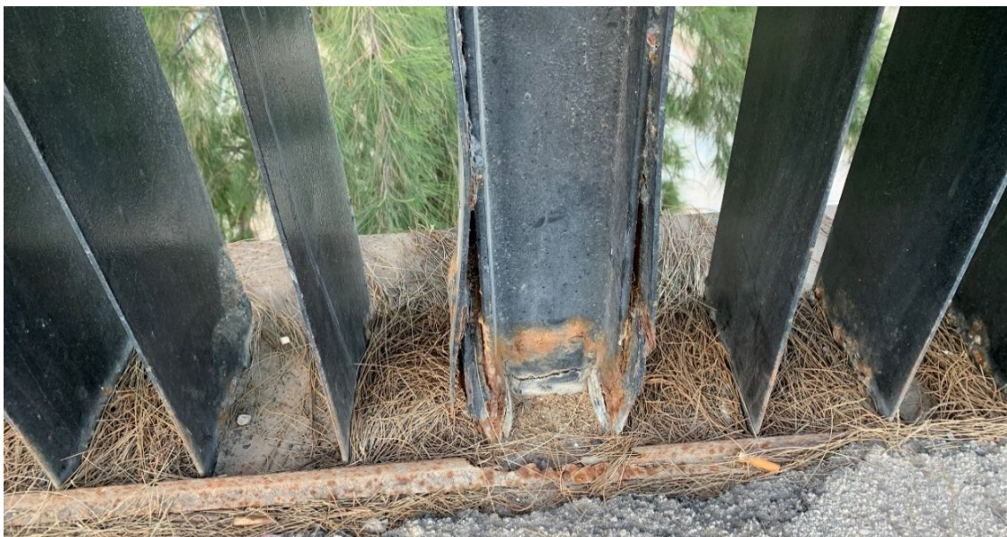
Imagen 51 Estado de deterioro de algunos montantes y lamas de la barandilla. (Fuente: elaboración propia).
