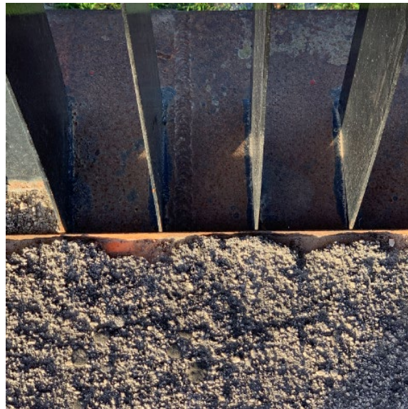
Imagen 8 estado del pavimento. (Fuente: elaboración propia)
