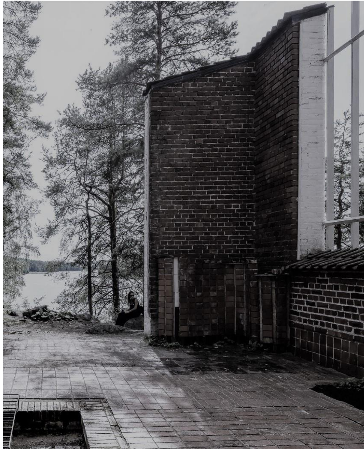
Figura 35. Aalto, Alvar. Casa experimental, Muuratsalo. 1953. Detalle del muro del patio. Fotografía de Pedro Iván Ramos. Fuente: https://de.wikiarquitectura.com/geb%C3%A4ude/city-of-saeynaetsalo/
