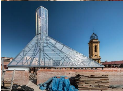
54 · Centro 1015. Chimenea solar (Mimbrero, 2019)
