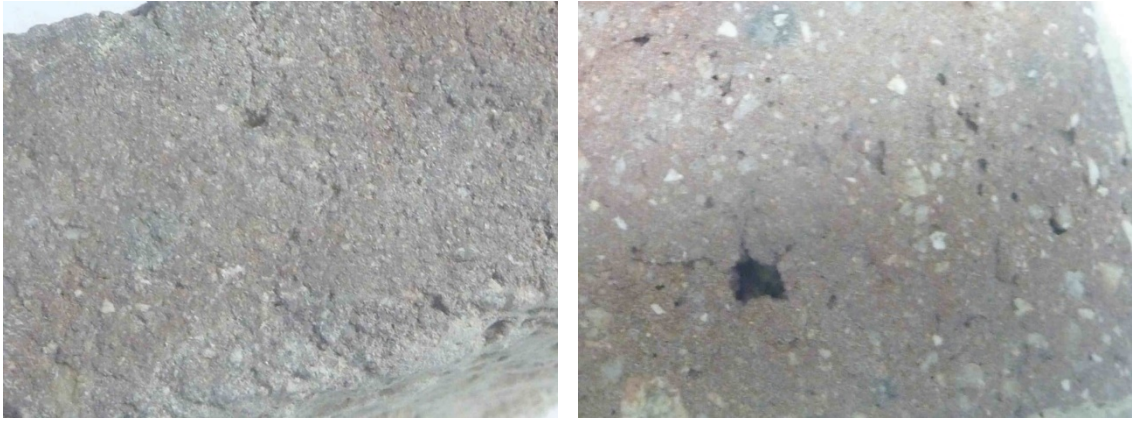
Detalles de la muestra M2. Suciedad superficial (izquierda) y matriz del ladrillo (derecha)
