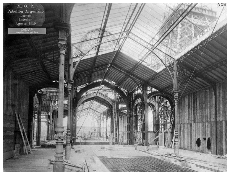
Figura 27: Construcción de la estructura del primer piso del Pabellón Argentino. (Chiesa & Brodaric, 2020)
