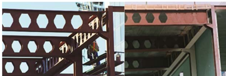
Figura 5 Viga alveolada: desajuste con proyecto y según proyecto
