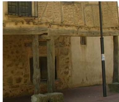
Figura 2. Deformaciones viga y pilar
