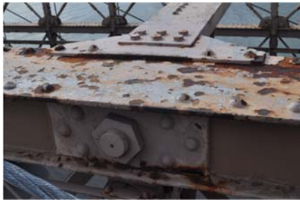
Figura 3. Corrosión de estructura metálica
