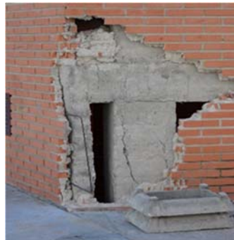
Figura 7. Daños en pilar
