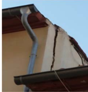
Figura 1. Grietas muro por acciones sísmicas
