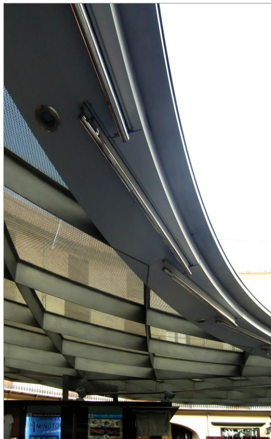
Fig. 101. Fotografia de detall de la cuberta, donde se ve la descomposició estructural, y el sistema de il·luminació y protecció solar. Fuente: Elaboración propia.
