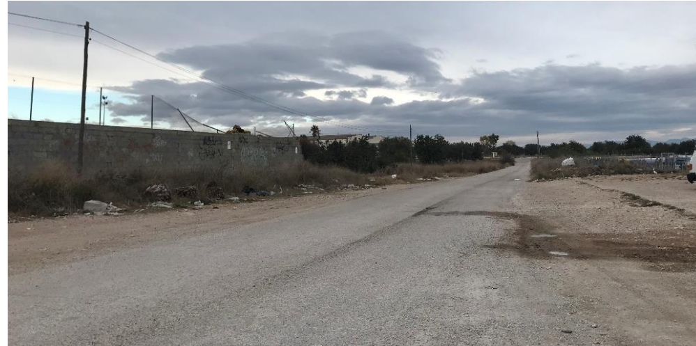
Figura 14. Estado de la carretera calle Canal Xúquer-Turia, cuenca N3
