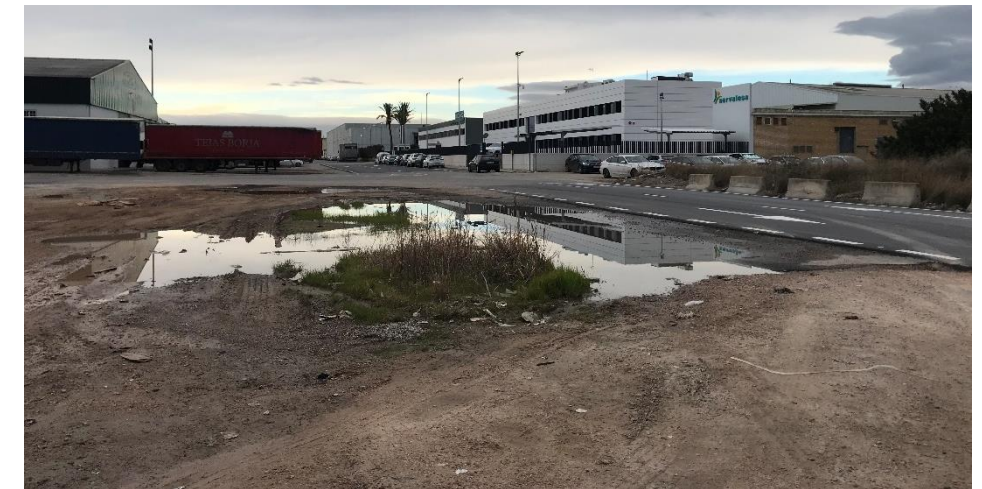
Figura 12. Estado de la carretera de la Pinadeta, cuenca N3
