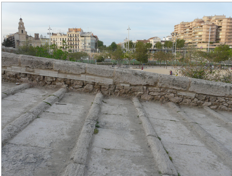
Rampa del cauce del Turia en el tramo del Portal de Serranos
