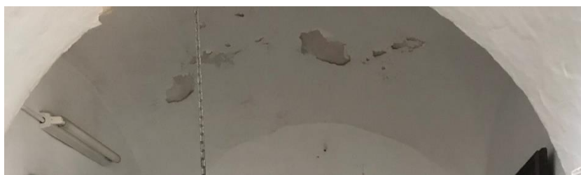
Fig.10: Detalle de humedades en el techo de la ermita.
