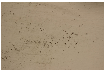
Fig.46: Acumulación de polvo sobre la pintura
