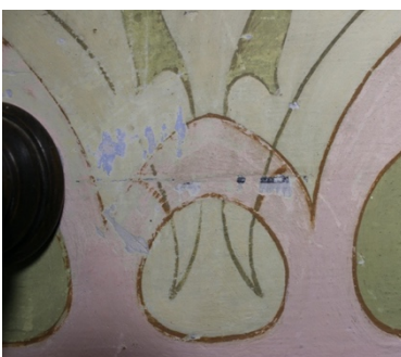
Fig.49: Daño producido por golpes y el roce de la cortina
