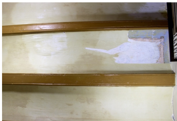
Fig.35: Zona de papel arrancado del techo
