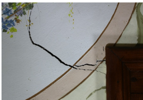
Fig.50: Grieta cerca de la puerta, pared oeste
