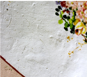
Fig.33: Detalle de cerdas del pincel adheridas a la pared
