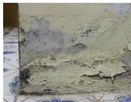
Fig.51: Zona afectada por la humedad
