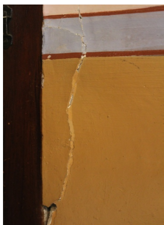
Fig.87: Grieta ubicada en el marco de la puerta principal
