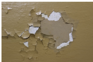
Fig.53: Craqueladuras del zócalo, pared norte
