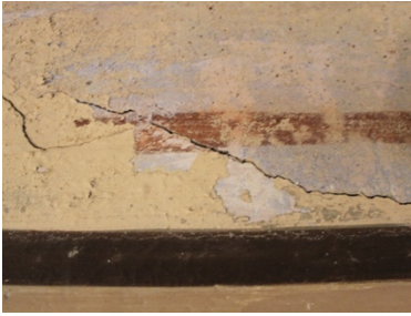
Fig.32: Zona pulverulenta con presencia de pintura subyacente
