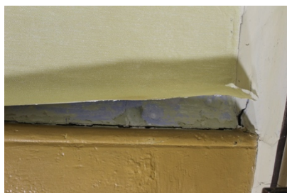
Fig.61: Papel despegado del techo debido a la humedad
