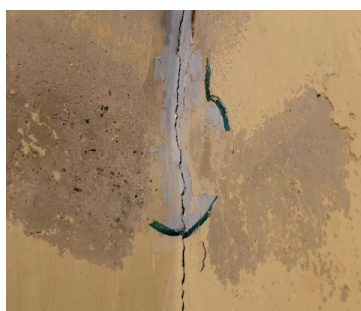
Fig.47: Laguna donde se aprecia el mortero
