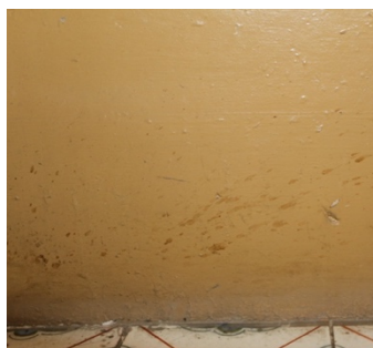
Fig.60: Salpicaduras sobre el zócalo
