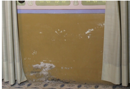
Fig.13: Zócalo, pared norte
