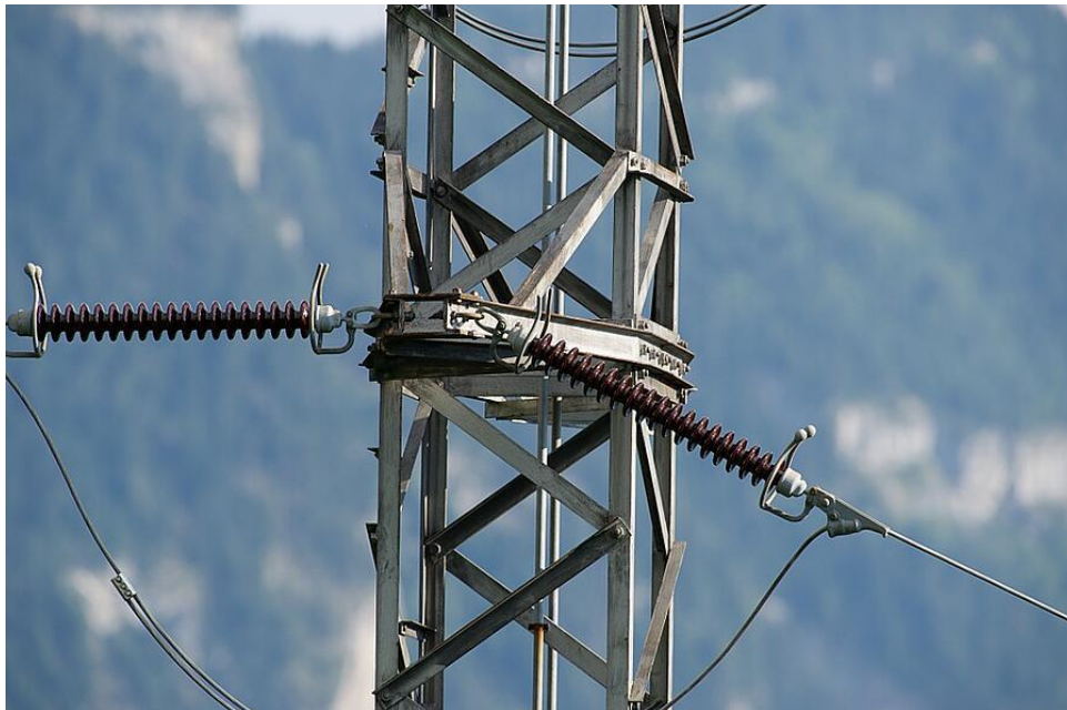
Ilustración 3: Aislador porcelánico en poste de tendido eléctrico. Fuente: https://blog.structuralia.com/aisladores-en-lineas-electricas-materiales-tipos-y-caracteristicas-principales
